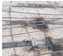
(d) Spalling at center
