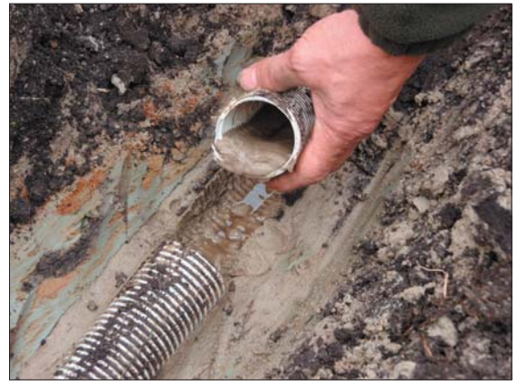
Kuva 8.11. Esimerkki Laheotsan kohteelta, jossa maalaji on karkea hieta ja ojitus on tehty ilman esipäällystettä. Ojitus on kaksi vuotta vanha ja siinä esiintyy saostumia.
