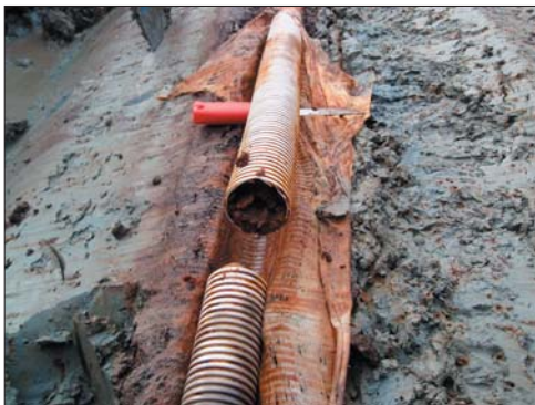
Kuva 8.3. Alavieska, kohde 1. Kymmenen vuotta vanha ensiojitus ohuella esipäällysteellä. Pintamaa on turvetta ja pohjamaa hiesusavea. Savespitoisuus on 32 %. Putkessa esiintyy ruostesaostumia.
