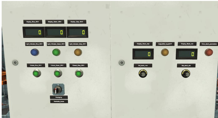
Figura 7: Panel de control almacén intermedio
