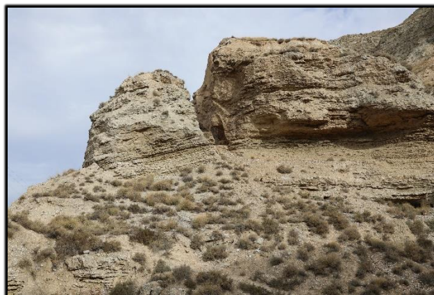
Figura 5. Vuelco asociado al escarpe principal yesífero, al pie del barranco principal en el pueblo de Remolinos.
