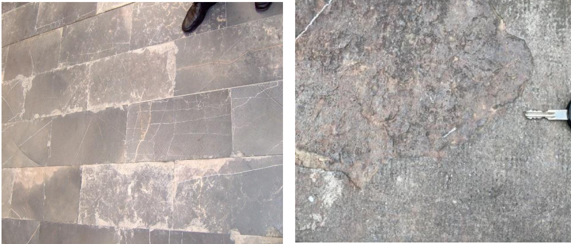
Figura 7. A) Aspecto de deterioro del pavimento de la Estación Intermodal de Zaragoza. Se observan baldosas con distinto grado de deterioro debido a que la composición de las mismas es diferente. Una mayor porosidad ocasiona menor resistencia a compresión, un alto contenido en arcilla puede provocar mayor expansión y fragmentación del bloque. B) Aspecto de deterioro y descamación de la caliza de Calatorao en la valla del campus de San Francisco, Universidad de Zaragoza (> 50 años a la intemperie). Si no hay descamación el color negro evoluciona a gris claro (oxidación de la materia orgánica). El color rojo solo se manifiesta en el dorso debido a que esta en un lugar protegido de la luz solar, es una prueba de que la oxidación que conlleva recristalización de óxidos de hierro a hematites es un proceso bacteriano, ya que el ultravioleta de la luz solar es bactericida y la recristalización de los óxidos de hierro a hematites por bacterias es un proceso frecuente en suelos rojos actuales que ya documento Choukrov et al. (1972) y Turner,P., (1981).
