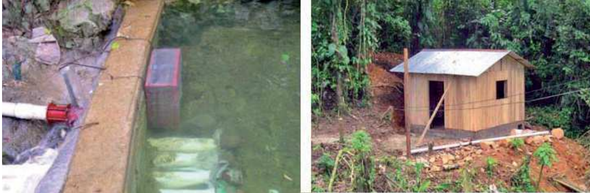
FIGURA 3. Fotografías de la presa (izquierda) y casa de máquinas (derecha) instalados por FHIA
