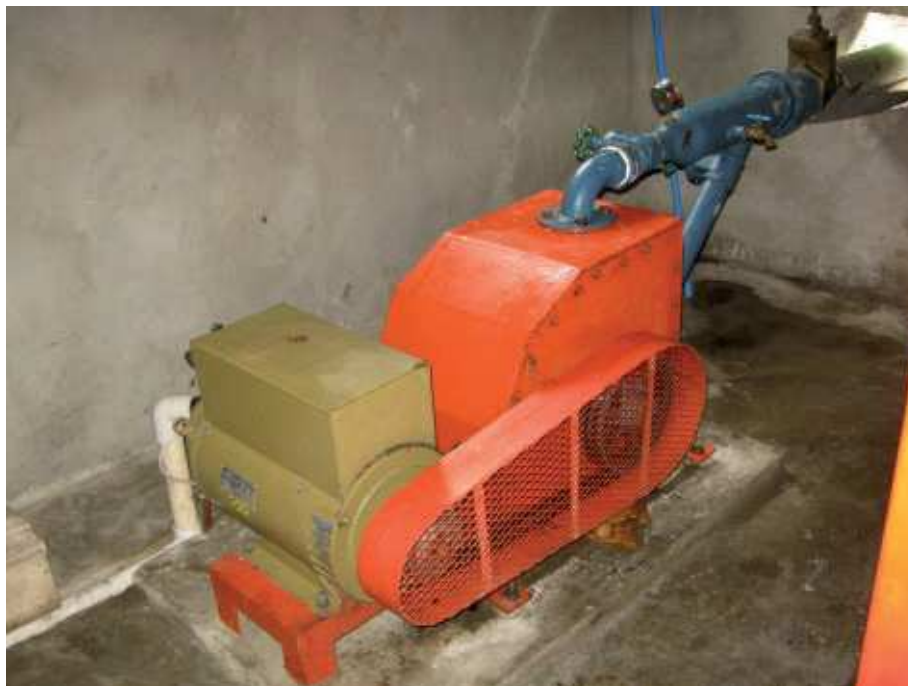
FIGURA 4. Turbina y generador desarrollados e instalados por FHIA
