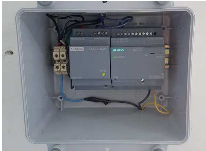
FIGURA 35. PLC Siemens instalado en la comunidad de San Miguelito
