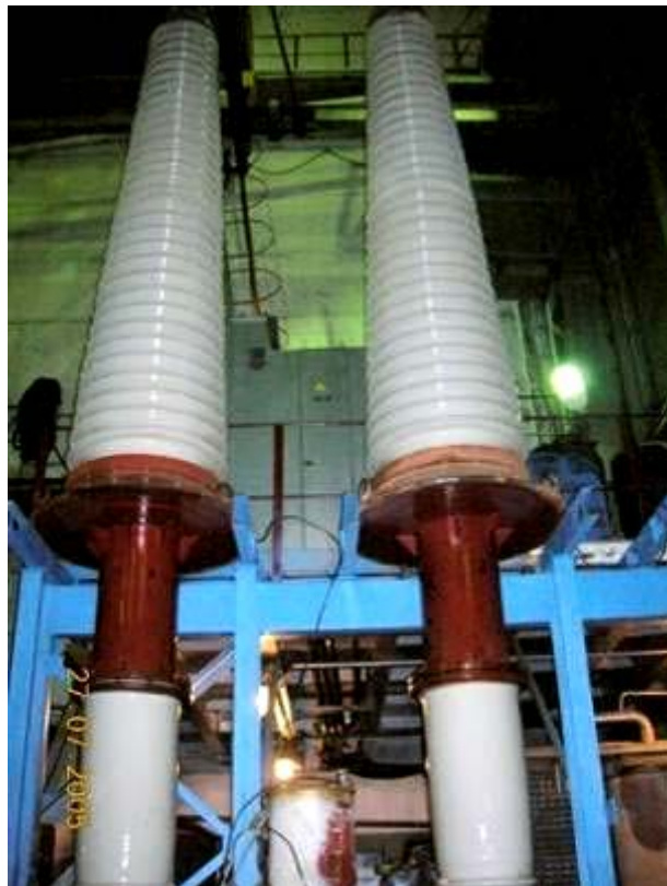
Рисунок 1.13 – Високовольтні вводи 500 кВ блочного трансформатора
