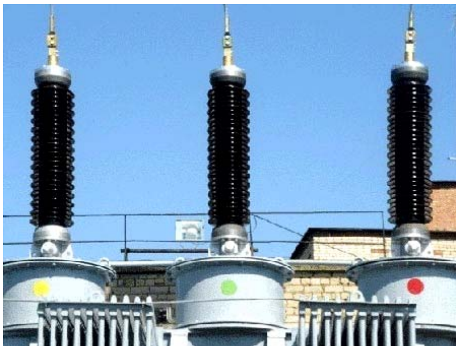
Рисунок 1.15 – Вигляд трансформатора з вводами з RIP-ізоляцією
