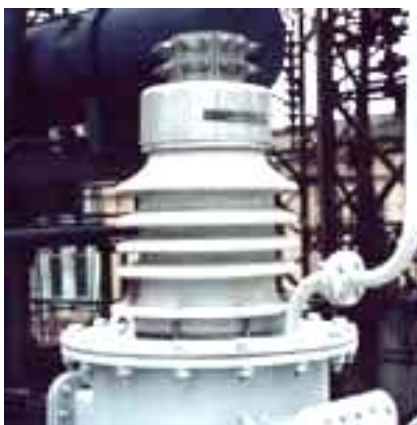
Рисунок 1.14 – Знімний ввід на напругу 20 кВ і струм 8000 А на силовому трансформаторі
