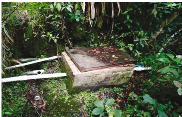
Figura 53 Conexión clandestina en la salida de los filtros.
