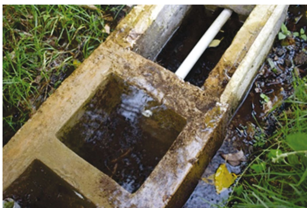
Figura 54 Presencia de pérdidas de agua en el desarenador actual de Tunjaque.
