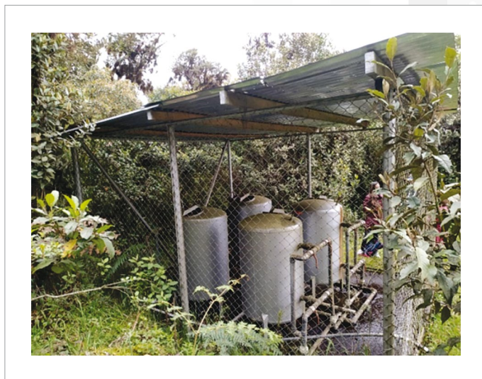
Figura 51 Sistema de filtración actual del acueducto Tunjaque.
