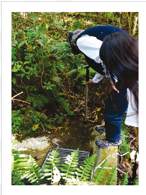
Figura 56 Aforo en la Bocatoma del acueducto Tunjaque.
