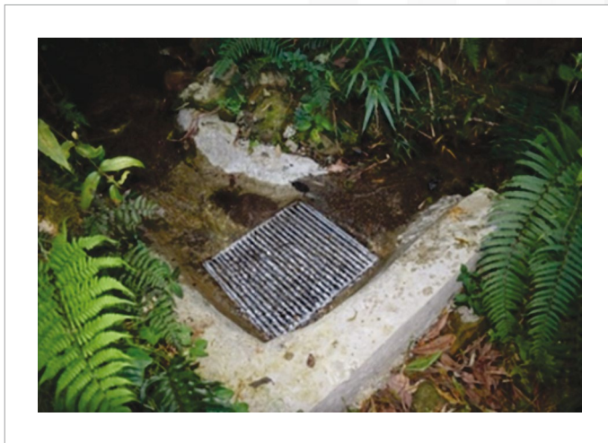
Figura 55 Bocatoma actual del acueducto Tunjaque.
