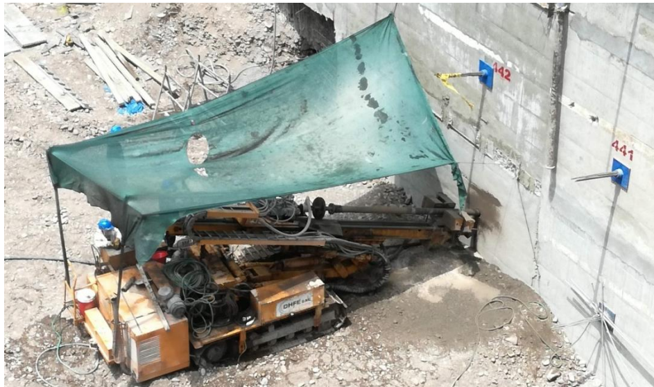
Figura 39. Perforación, colocación de cables e inyección de Grout (Fuente: Registro fotográfico de la obra Camino Real)
