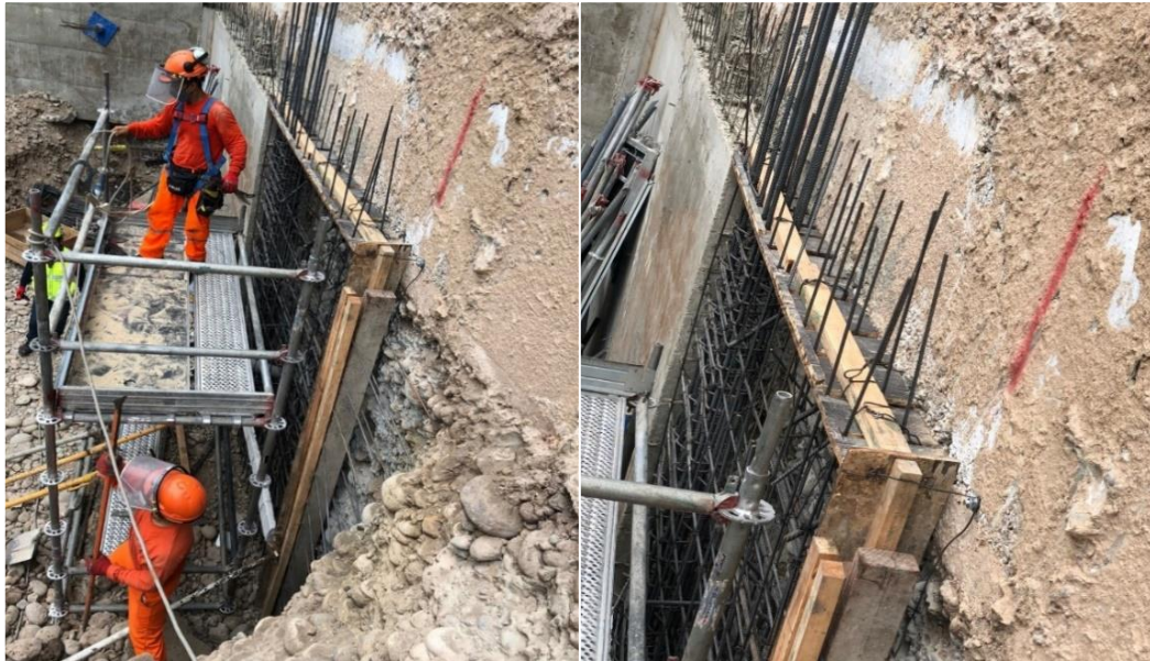
Figura 64. Armado de encofrado lateral – Método Shotcrete (Fuente. Registro fotográfico de la obra Camino Real)
