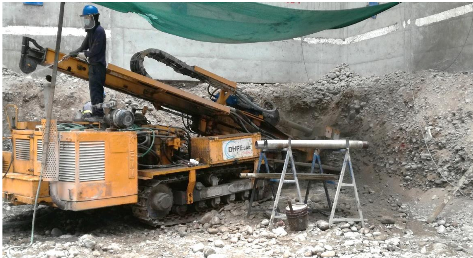
Figura 38. Formación o Ejecución de la banqueta de seguridad para perforación (Fuente: Registro fotográfico de la obra Camino Real)
