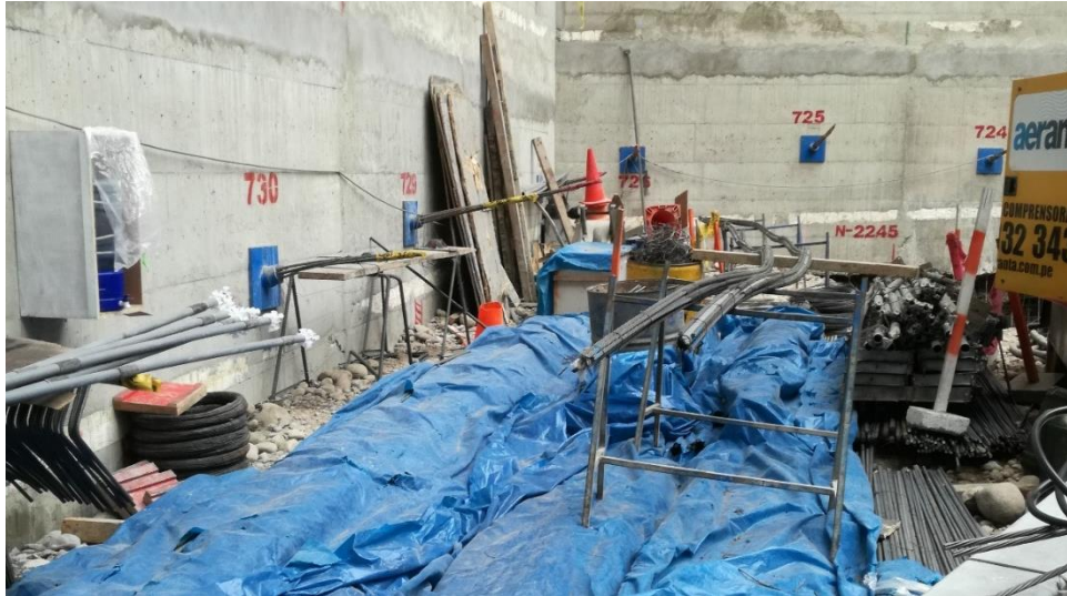
Figura 48. Banco de acero (Fuente. Registro fotográfico de la obra Camino Real)
