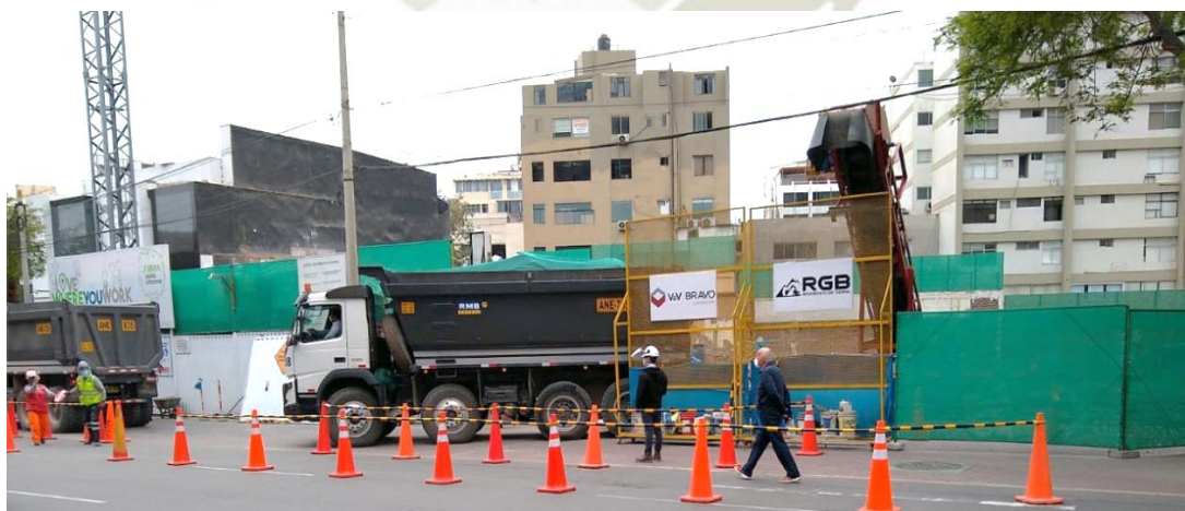
Figura 12. Vista del Frontis de Camino Real (Fuente: Registro fotográfico de la obra Camino Real)
