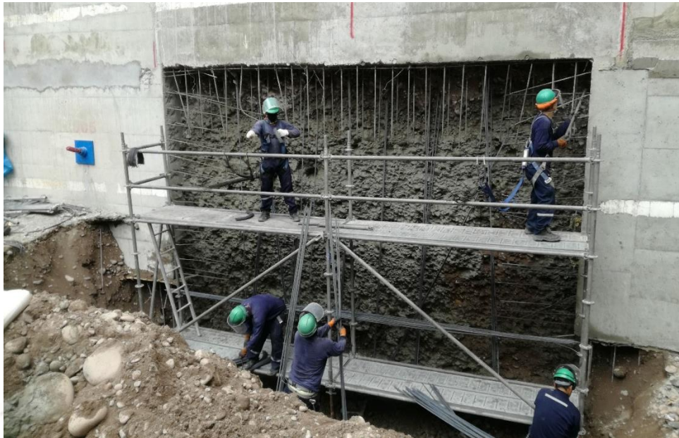
Figura 46. Instalación de la malla de acero (Fuente. Registro fotográfico de la obra Camino Real)
