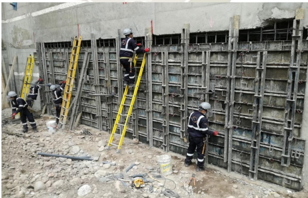
Figura 53. Encofrado con paneles fenólicos (Fuente. Registro fotográfico de la obra Camino Real)
