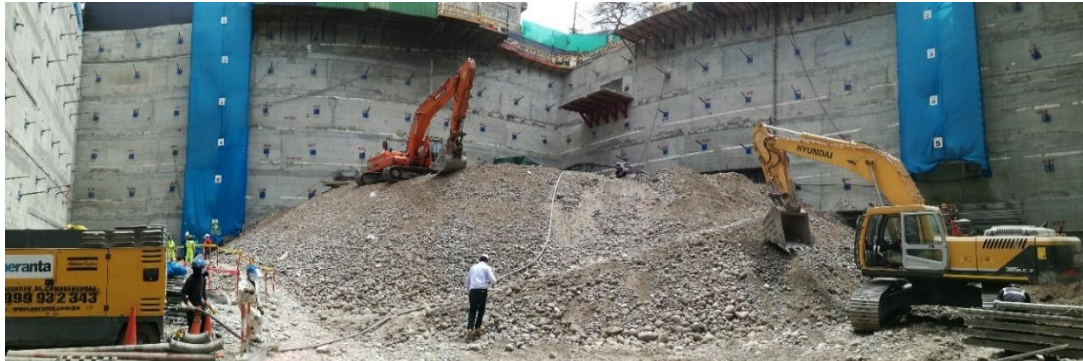
Figura 79. Conjunto de material a eliminar que dificulta la ejecución de muros anclados (Fuente. Registro fotográfico de la obra Camino Real)
