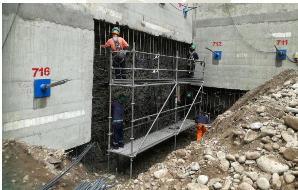
Figura 47. Instalación de la malla de acero paño en esquina (Fuente. Registro fotográfico de la obra Camino Real)
