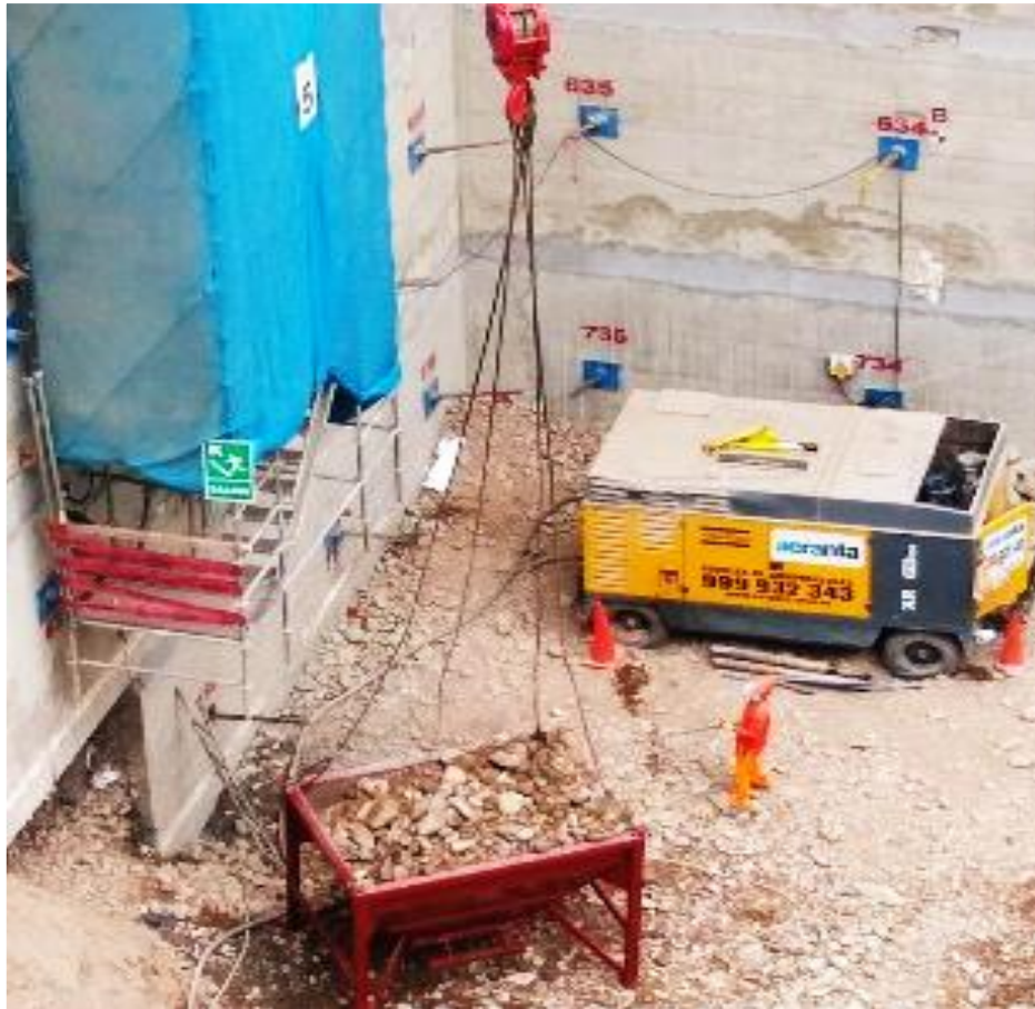
Figura 7. Eliminación con el uso de Grúa y baldes basculantes (Fuente. Registro fotográfico obra Camino Real)
