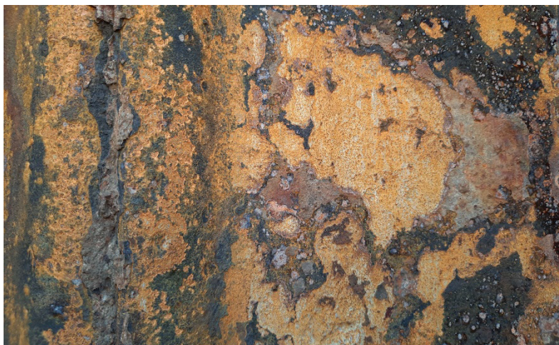
Bild 1: Durch MIC verstärkter Korrosionsangriff an einer unbeschichteten Spundwand (Einsatzzeit ca. 10 Jahre), Foto: WSA Spree-Havel.
