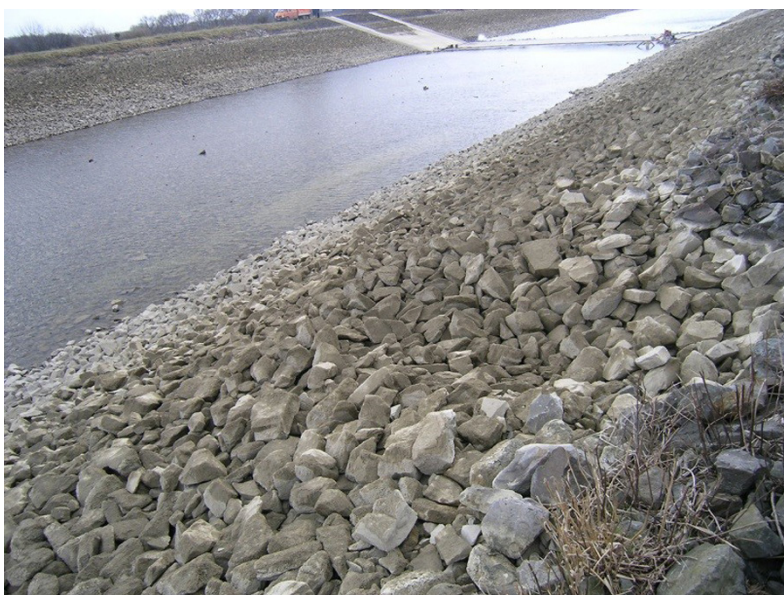
Bild 1: Beispiel für einen Deckwerksschaden infolge des Schraubensstrahls eines manövrierenden Schiffes am DEK, Los2b (2006).
