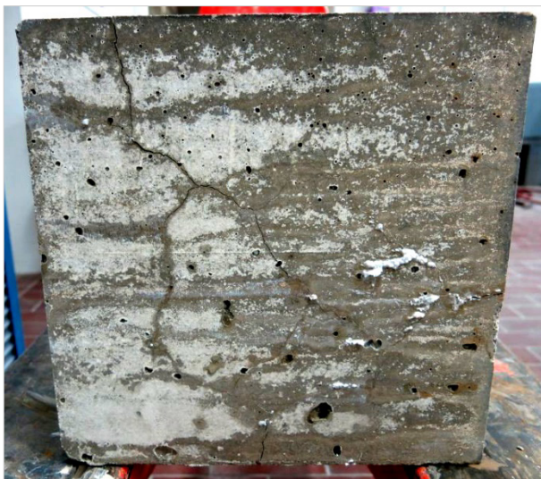
Bild 1: Prüfkörper Performance-Prüfung mit AKR-typischen Netzrisse.
