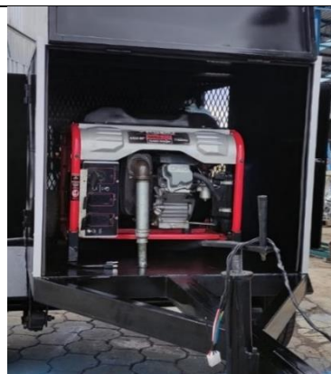
Figura 3. 29 Parte frontal con generador
