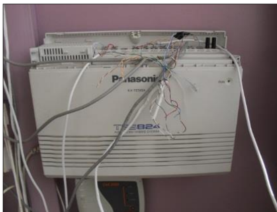
Figura 30. Central telefónica del Hospital de Ibarra - IESS Fuente: (Hospital de Ibarra - IESS, 2019)
