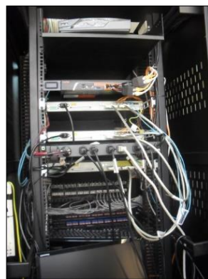
Figura 23. Rack ED1 – Rack Principal Ubicado en el cuarto de Telecomunicaciones Fuente: (Hospital de Ibarra - IESS, 2019)
