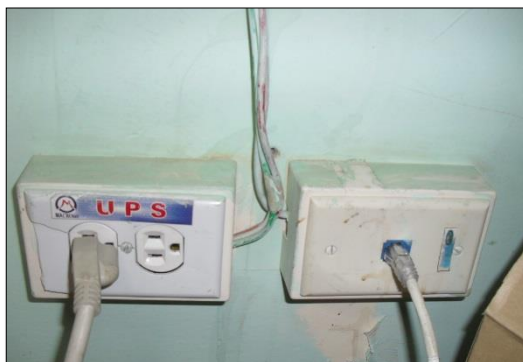
Figura 28. Puntos de red y patch cord sin etiquetado Fuente: (Hospital de Ibarra - IESS, 2019)
