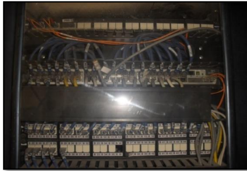
Figura 24. Rack ED2 – Ubicación en el área de Rayos X Fuente: (Hospital de Ibarra - IESS, 2019)
