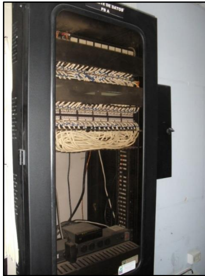
Figura 26. Rack ED4 – Ubicación Estadística Fuente: (Hospital de Ibarra - IESS, 2019)
