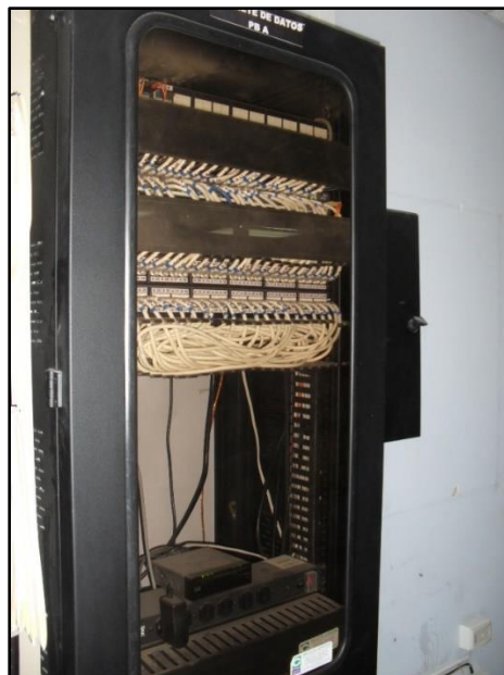
Figura 25. Rack ED3 – Ubicación Estadística Fuente: (Hospital de Ibarra - IESS, 2019)
