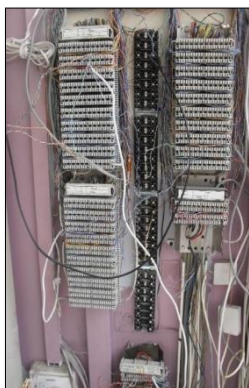
Figura 31. Armario de telecomunicaciones Hospital de Ibarra – IESS Fuente: (Hospital de Ibarra - IESS, 2019)
