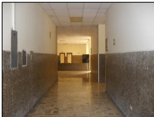
Figura 41. Consulta externa del Hospital de Ibarra – IESS Fuente: (Hospital de Ibarra - IESS, 2019)
