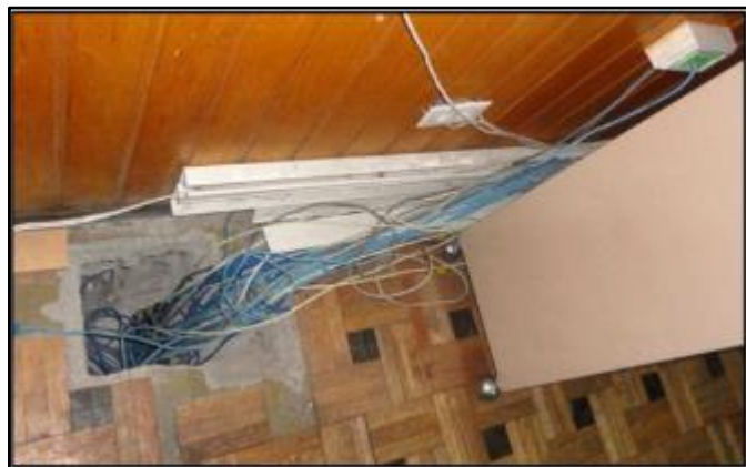
Figura 20. Recorridos del cableado vertical Fuente: (Hospital de Ibarra - IEES, 2019)
