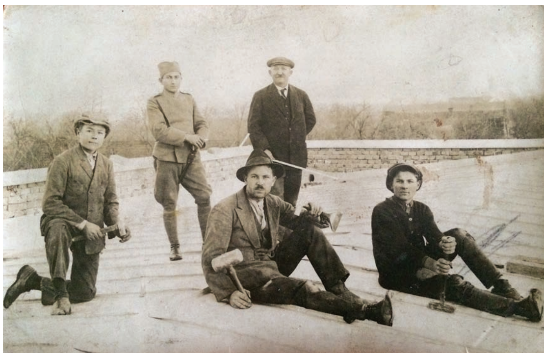
Fotografia 3. Robotnicy na dachu budynku kościoła ewangelicko-augsburskiego podczas budowy (Potisský Sv. Mikuláš, około 1929 roku). Archiwum prywatne G. Poljaka.
