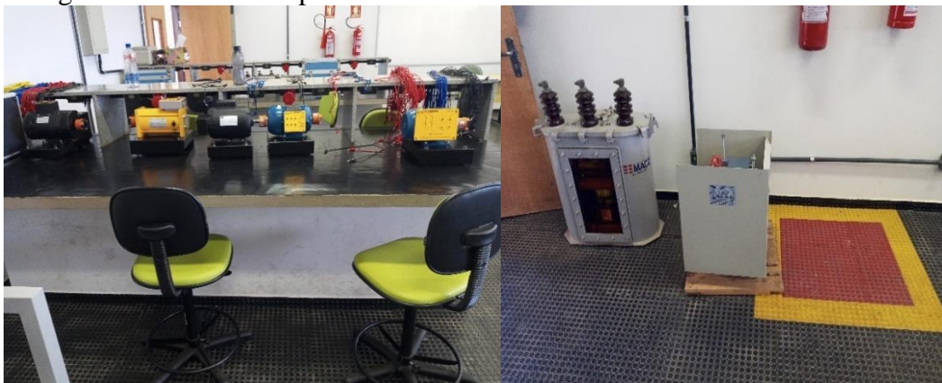
Figura 19: Bancadas e piso no Laboratório de Circuitos e Medidas Elétricas.
