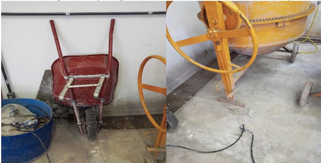
Figura 9: Fiação exposta no Laboratório de Materiais de Construção
