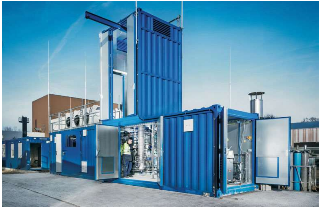
Abb. 9: Dreiphasen-Methanisierungsanlage des EBI ceb im „Energy Lab 2.0“ (CH 4 -Produktion: 10 m 3 /h)
