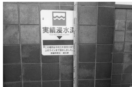
写真-2 令和元年 8 月豪雨実績浸水深看板
