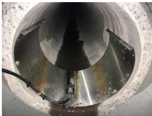
Figure 11: Position de la sonde du débitmètre dans RP-1
