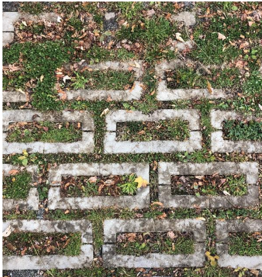
Figure 95: Pavé alvéolé le 5 novembre 2021
