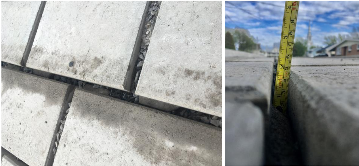
Figure 46: État du pavé après le balayage du printemps 2020
