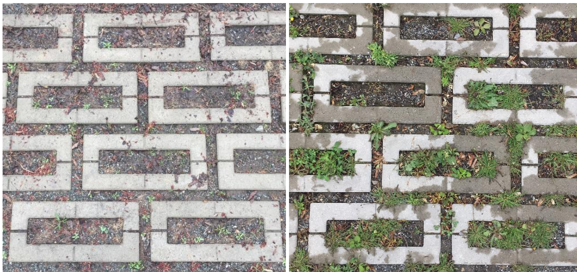
Figure 78: État du pavé alvéolé le 26 mai 2021 (à gauche) et le 9 juillet 2021 (à droite)
