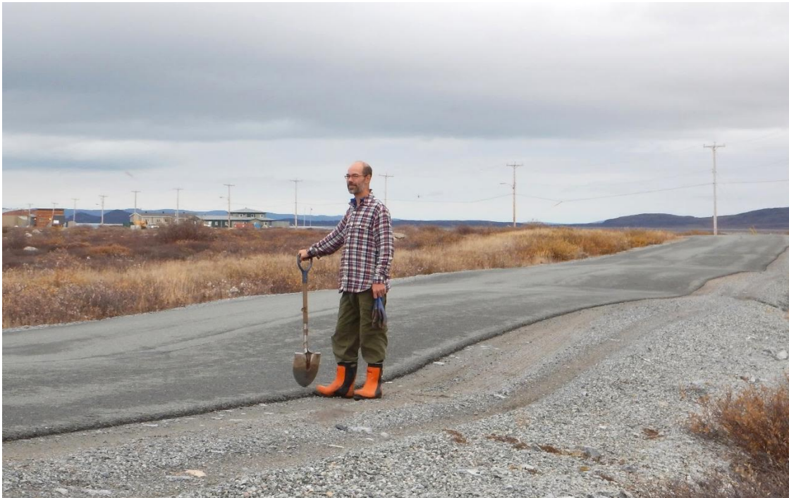
Figure 20 : Tassement différentiel observé le long de la route d'accès à l'aéroport, Tasiujaq (L'Hérault et al. , 2014.).
