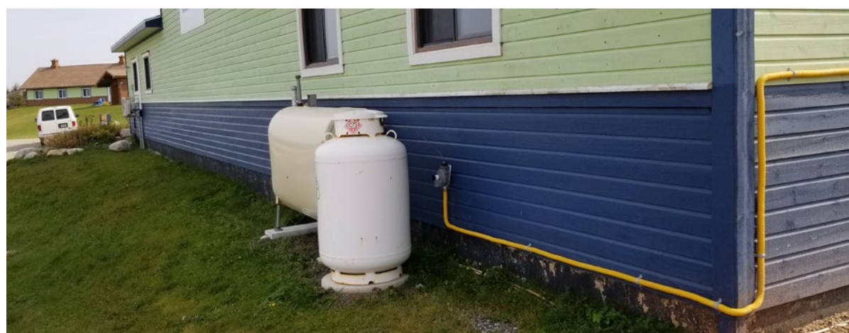
Réservoirs domestiques d'hydrocarbures.
