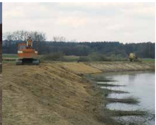
Photo 92. Aménagement «écologique» ! Villers-sur-Lesse, novembre 2009 (Région wallonne, Direction des Cours d'eau non navigables).
