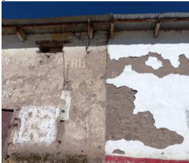
Figura 10: Vulnerabilidad sísmica en viviendas de adobe
