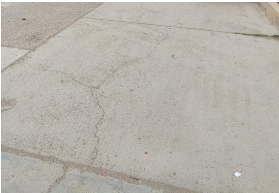
Figura 2 : Falla losa dividida
