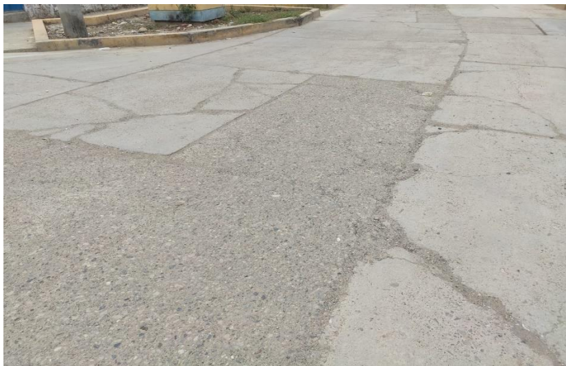
Figura 9 Falla de descascaramiento de juntas
