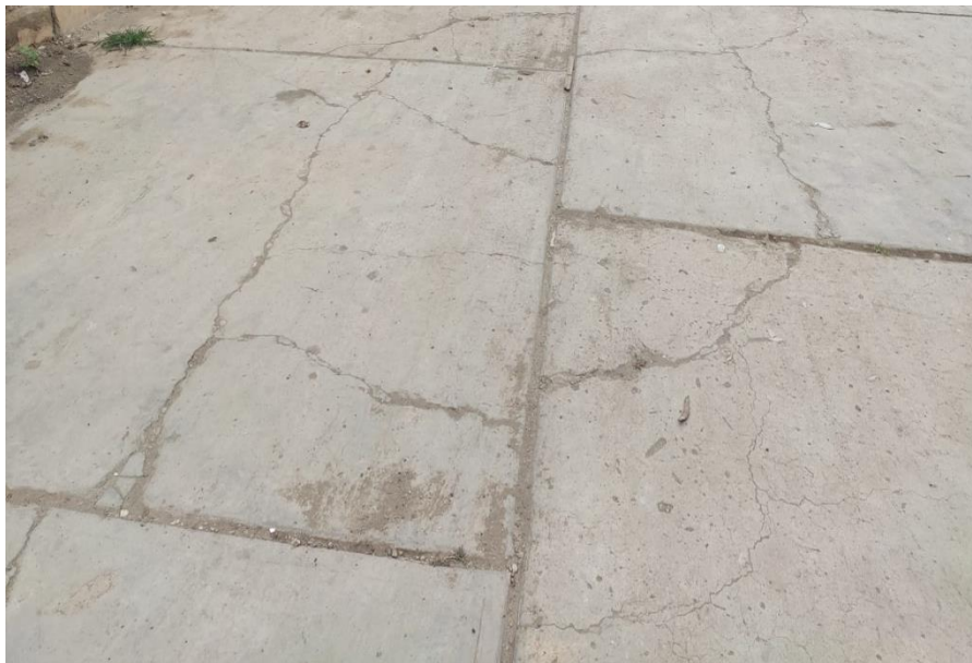
Figura 3 Falla del daño del sello de la junta, fisuras transversales y roturas
