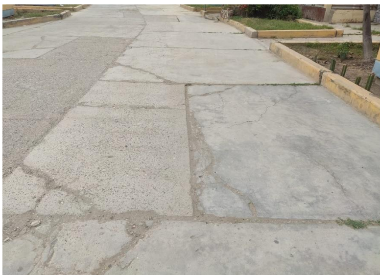
Figura 10 NO cuenta con drenaje
