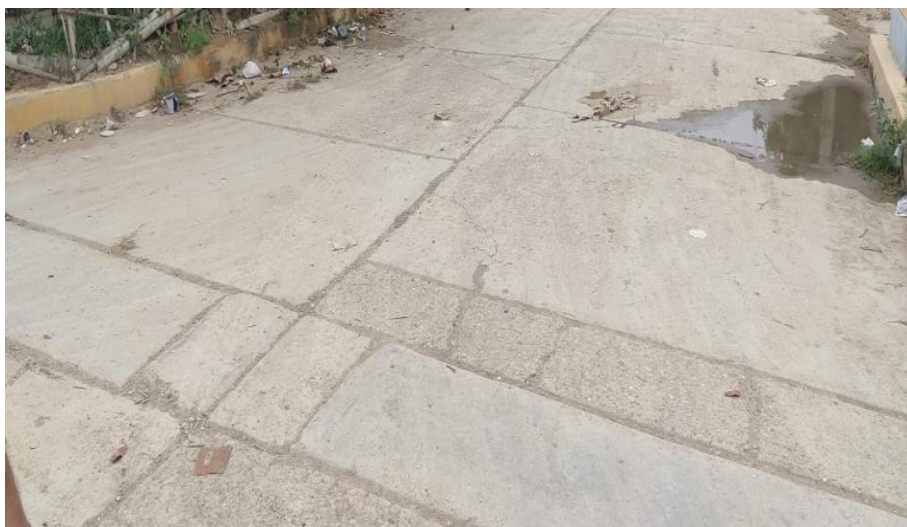
Figura 6 Falla de parche pequeño
