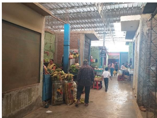
Infraestructura en malas condiciones
