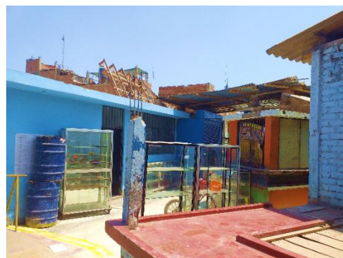
Infraestructura en mal estado
