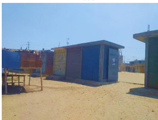
Infraestructura en mal estado – Tipologías de Puestos de venta
