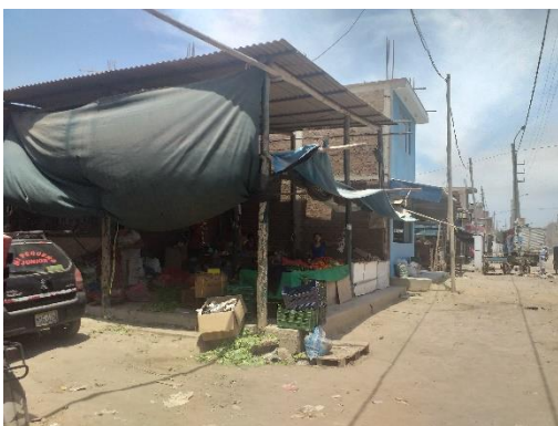
Mal estado de los puestos de venta
