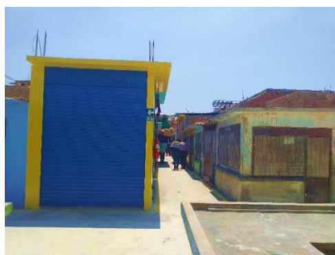
Infraestructura en mal estado – Tipología de los Puestos de venta
