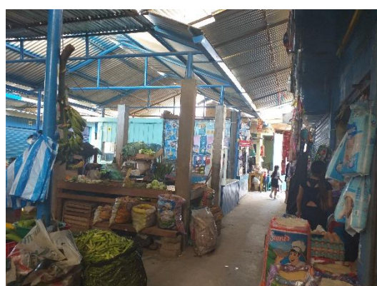
Infraestructura en mal Estado
