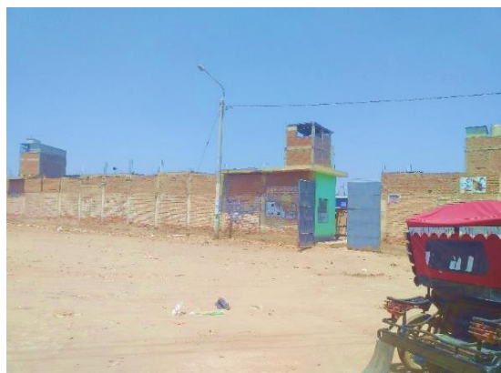
Infraestructura - Cerco Perimétrico y calles en mal estado
