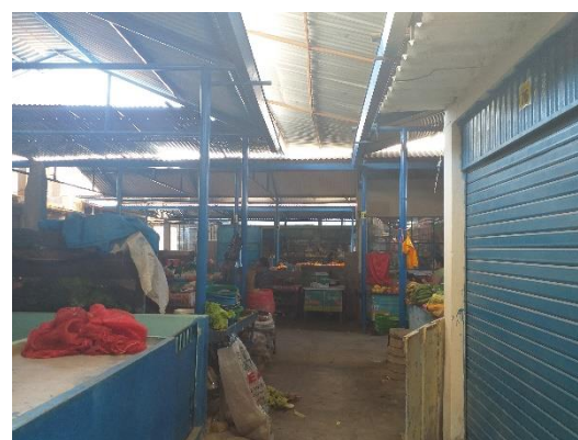
Cobertura en mal estado
