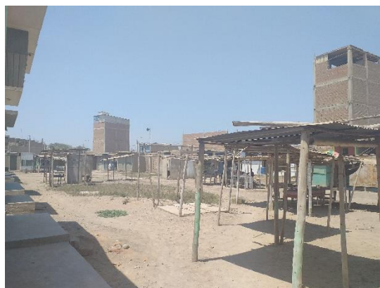
Infraestructura General en mal estado
