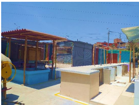
Infraestructura en mal estado – Tipología de los Puestos de venta
