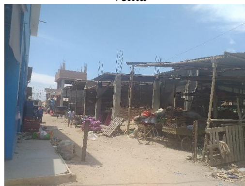
Mal estado de los puestos de venta
