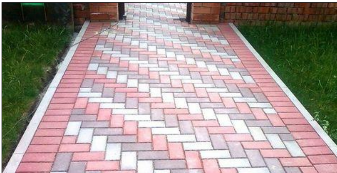
Figura 16. Apariencia de un pavimento articulado
