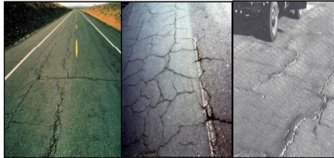
Figura 3. Agrietamiento en bloque
