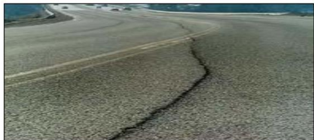
Figura 15. Grietas Longitudinales y transversales
