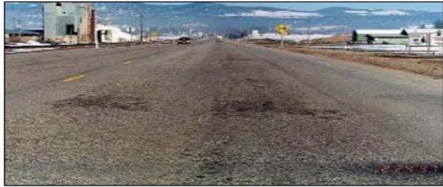
Figura 20. Desprendimiento de agregados
