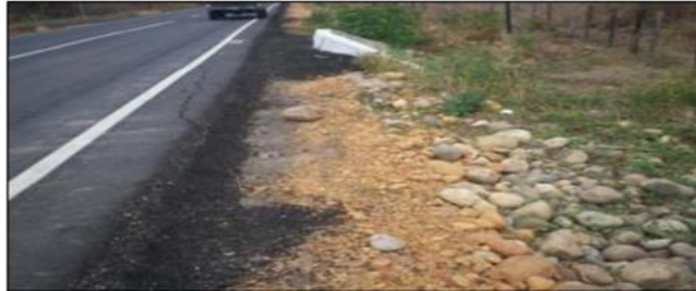
Figura 12. Grieta de Borde
