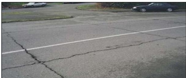
Figura 13. Grieta de reflexión de Junta
