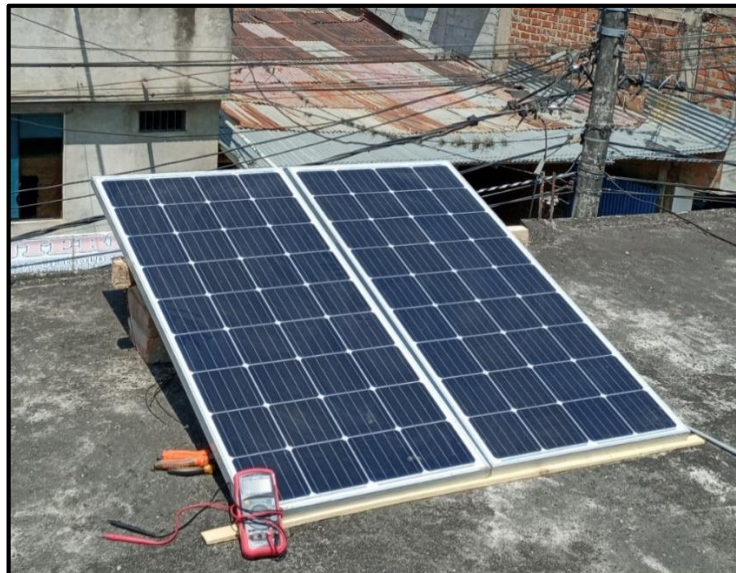
Pruebas realizadas del rendimiento de los módulos fotovoltaicos en 17°grados de inclinación respecto a la horizontal.
