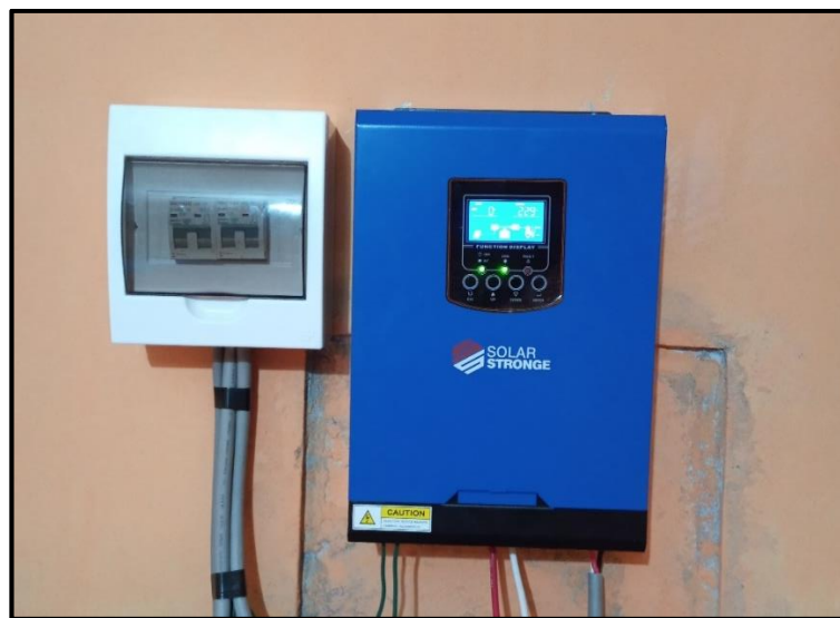
Inversor híbrido de onda sinusoidal pura de 1000 watts de potencia y tablero de distribución de energía eléctrica.
