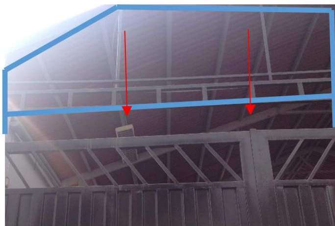
Figura 149. Espacio de puerta a techo del CIAM Ate. Fotografía tomada por el autor
