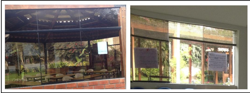
Figura 142. Ventanas de los talleres del CIAM La Molina Fotografías tomadas por el autor
