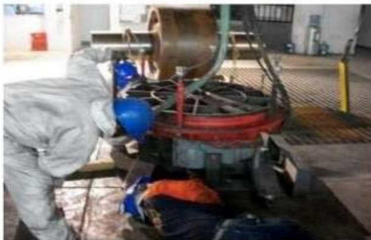
Foto 8 cara inadecuada modo de trabajo de alto riesgo
