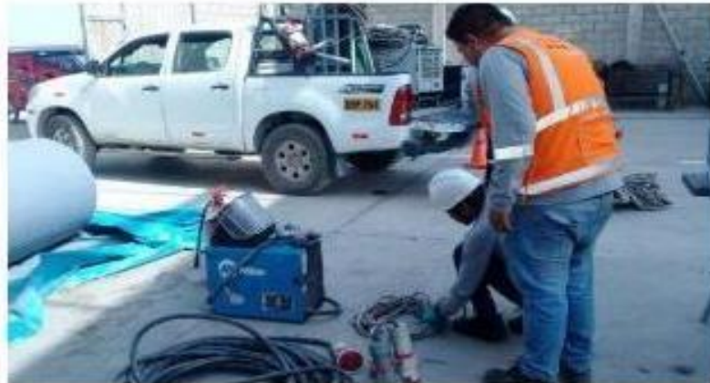
Foto 2 Falta de supervisión e incumplimiento de uso de EPP
