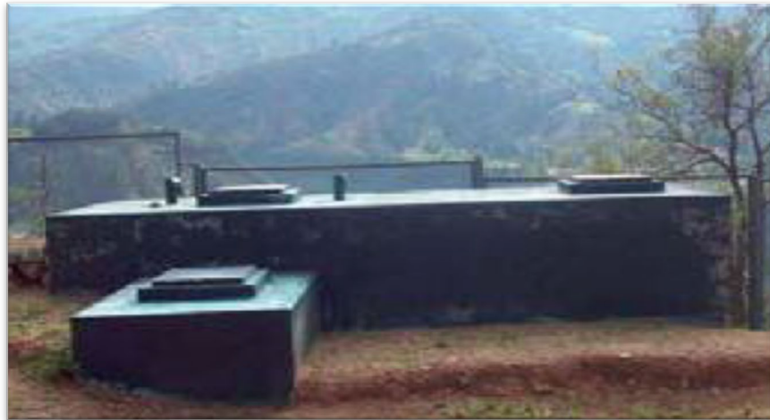
Figura 20. Planta de tratamiento
