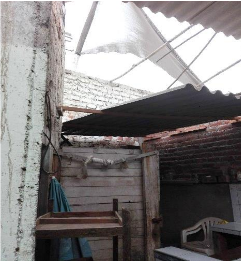
Figura 27: Techos en mal estado - Huanchaco Fuente: Elaboración propia
