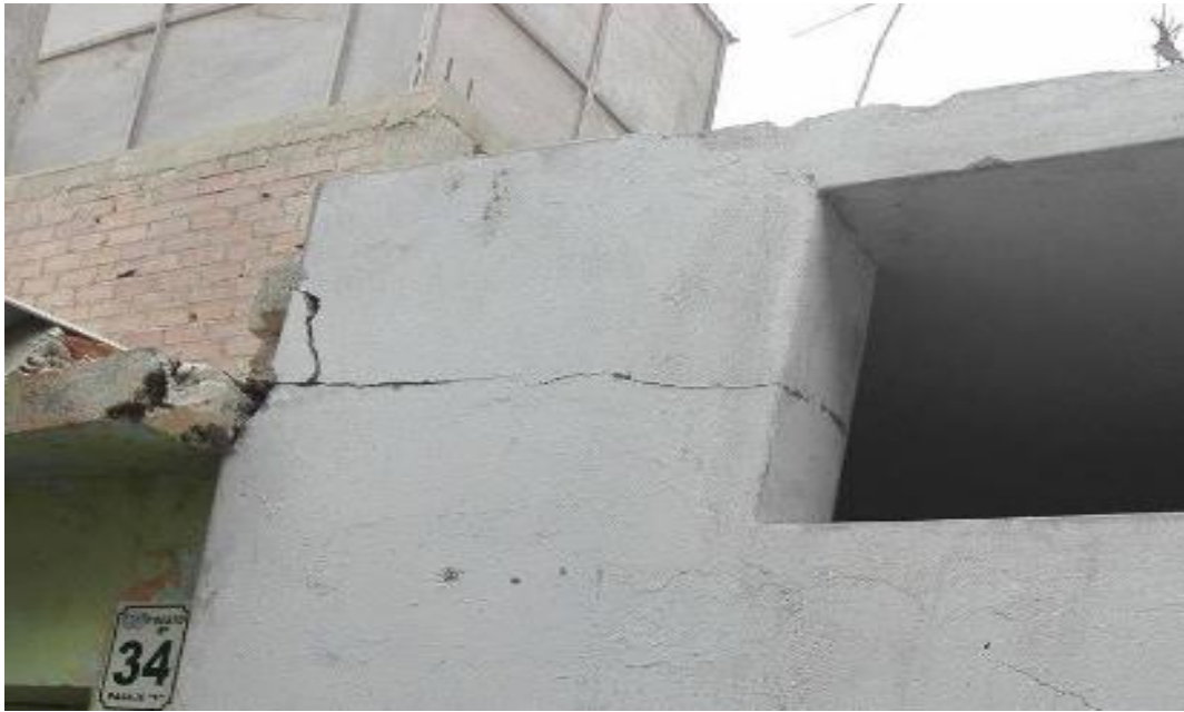
Figura 25: Fisuras en las paredes- Huanchaco Fuente: Elaboración propia
