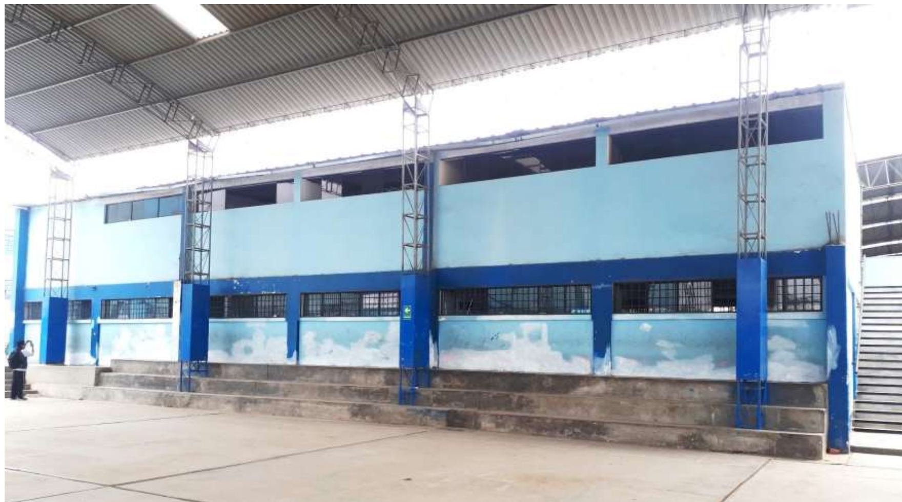
Columna Corta – Falla Inevitable en M3
