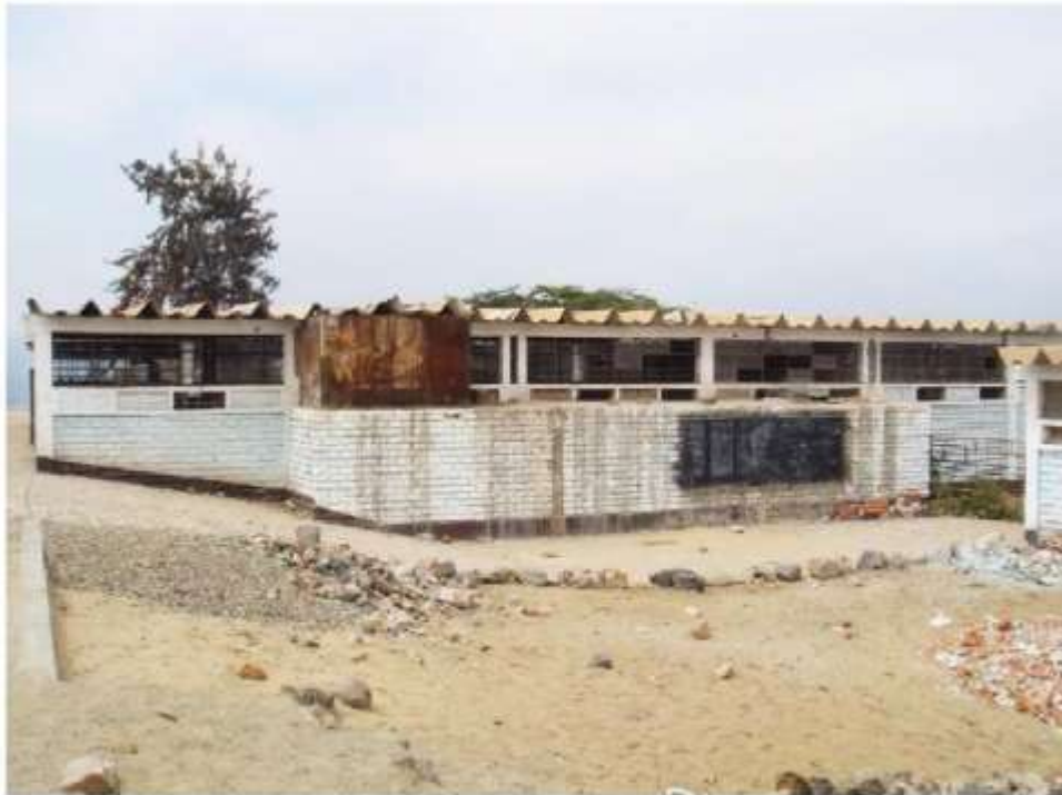
FOTO N° 05 : EN LA VISTA SE COMPRUEBA LA FALTA DE AMBIENTES MODERNOS PARA LOS ESCOLARES. EXISTIENDO EN SU LUGAR SALONES A PUNTO DE COLAPSAR
