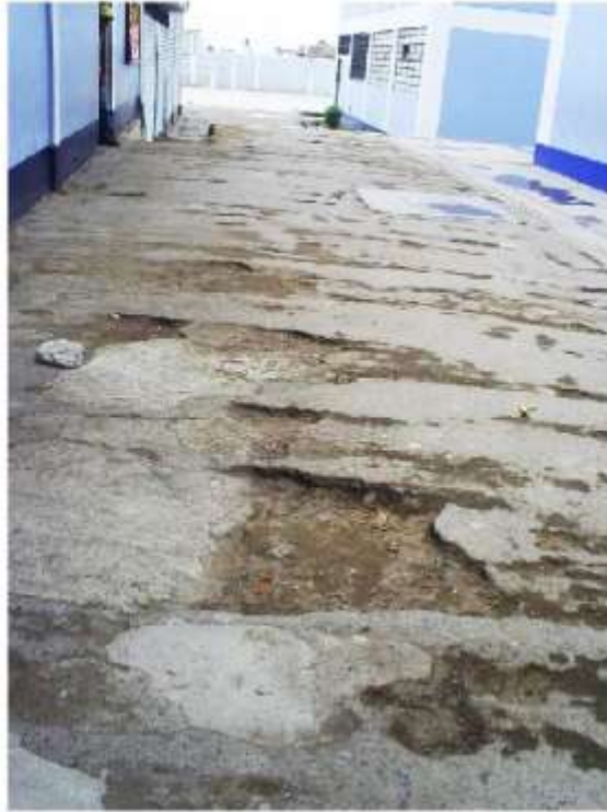
FOTO N° 07 : PISOS EN MAL ESTADO CON EL CONSIGUIENTE PELIGRO PARA LOS ESTUDIANTES
