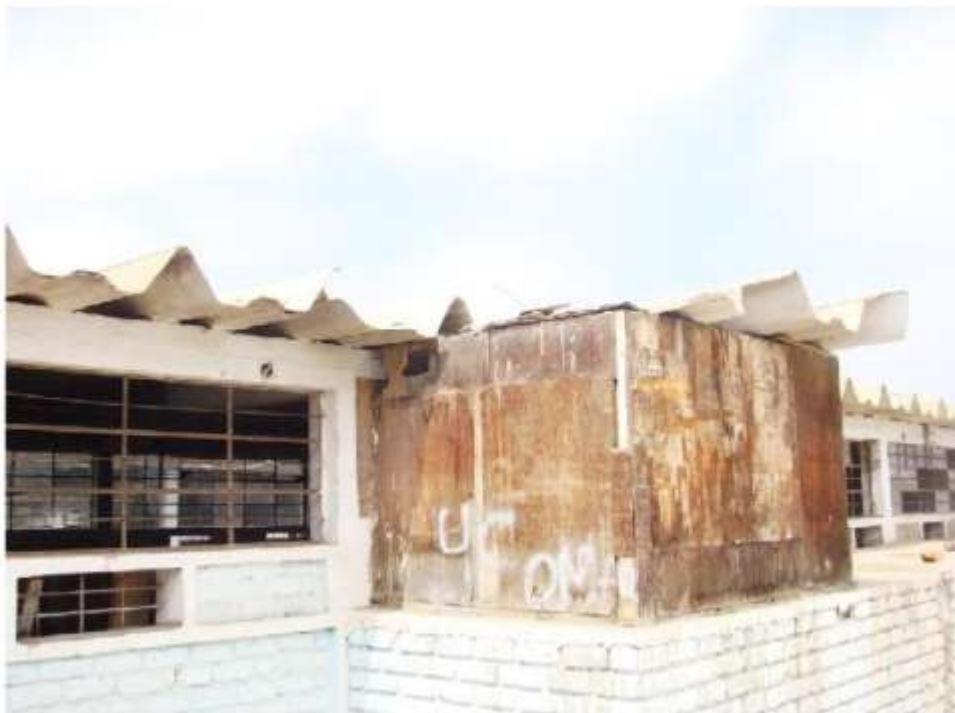
FOTO N° 06 : SE MUESTRA EL SUO DE TRYPLAY EN LOS AMBIENTES DE LOS ALONES, CON LUNAS ROTAS Y CON ETERNIT COMO TECHO.
