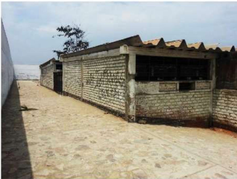
FOTO N° 08 : SE MUESTRAN MAS AMBIENTES ANTIGUOS CON TECHO ETERNIT GOLAP5ADO, VENTANAS EN MAL ESTADO.
