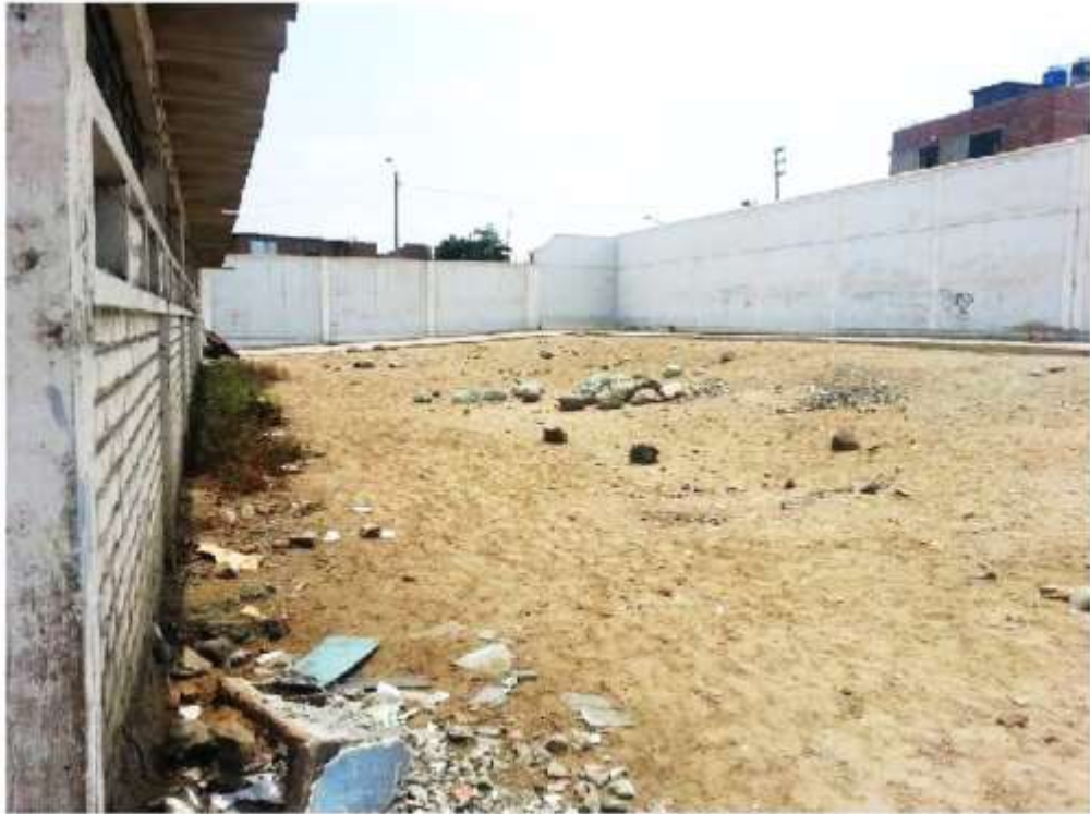
FOTONº 03 : SE APRECIA LA FALTA DE AMBIENTES PARA EL USO DE LOS ESCOLARES
