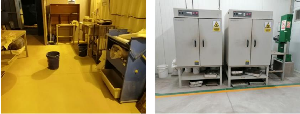
Fotografía 3: Elementos fuera de lugar y en zonas de riesgo
