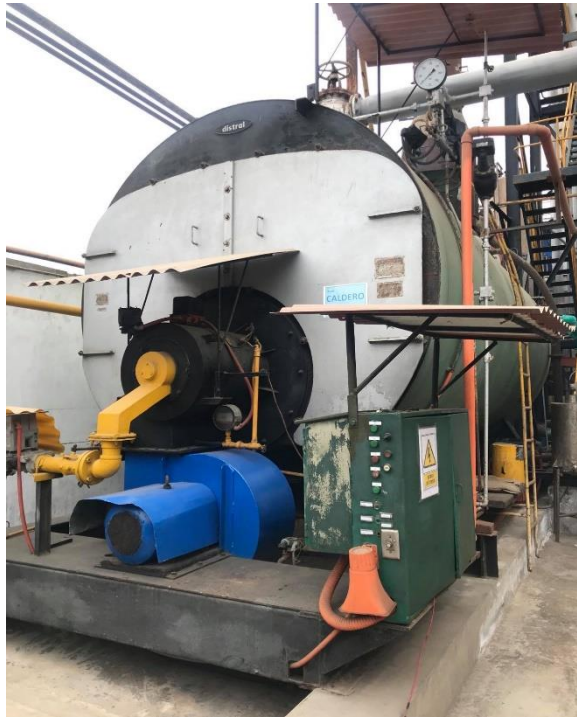
N° DE MÁQUINAS: 1 caldero
