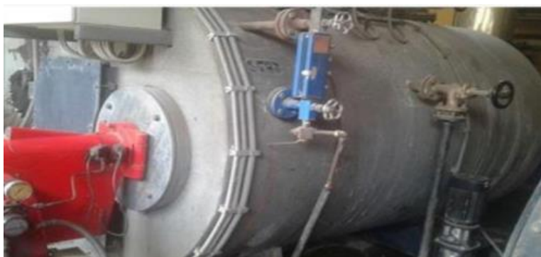
FIGURA 3. CALDERO PIROTUBULAR DE LA EMPRESA DON FERNANDO S.A.C FUENTE: ELABORACIÓN PROPIA
