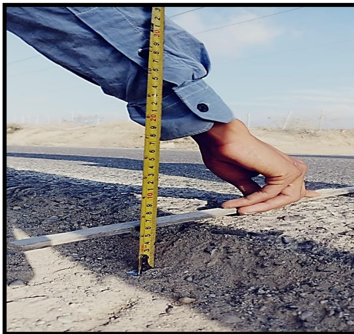
Imagen: Falla de tipo desnivel de berma
