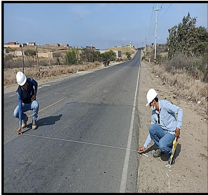
Imagen: Falla de tipo parcheo
