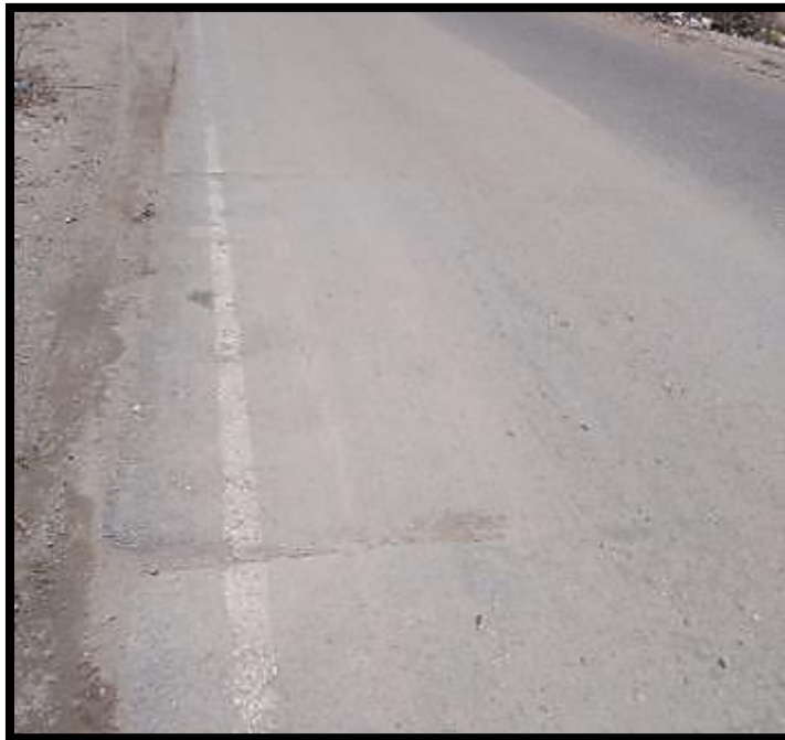
Imagen: Falla de tipo parcheo
