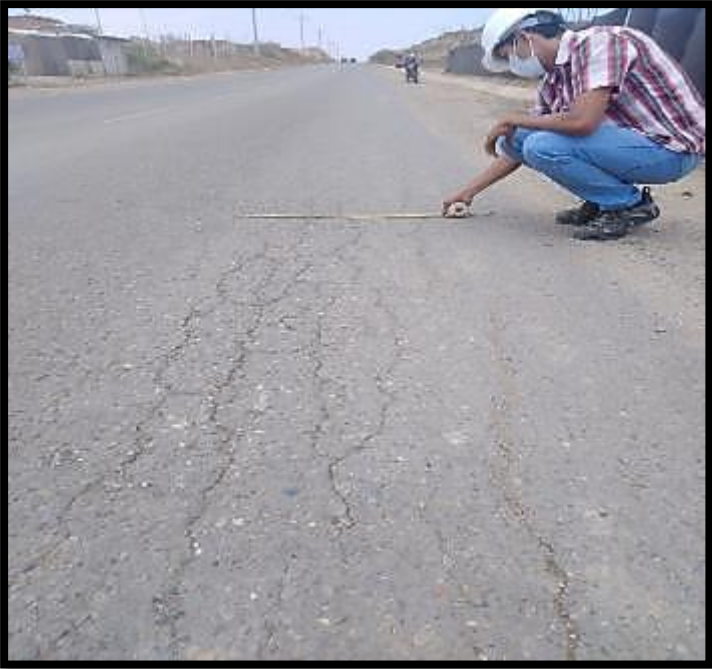
Imagen: Falla piel de cocodrilo.
