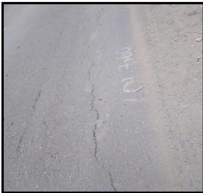
Imagen: Falla de tipo grieta longitudinal
