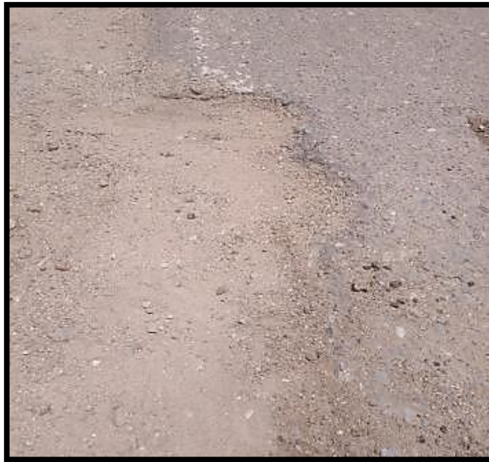
Imagen: Falla de tipo hueco
