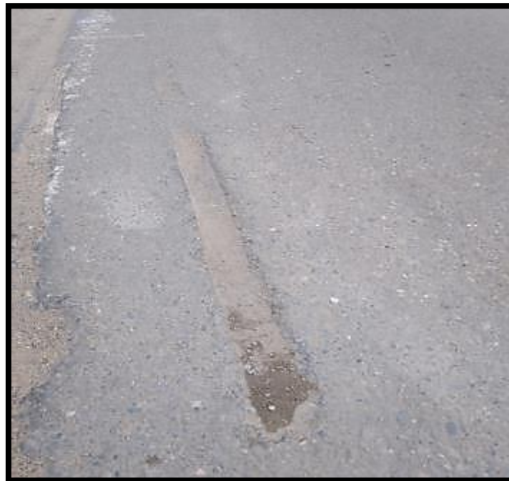
Imagen: Falla de tipo ahuellamiento
