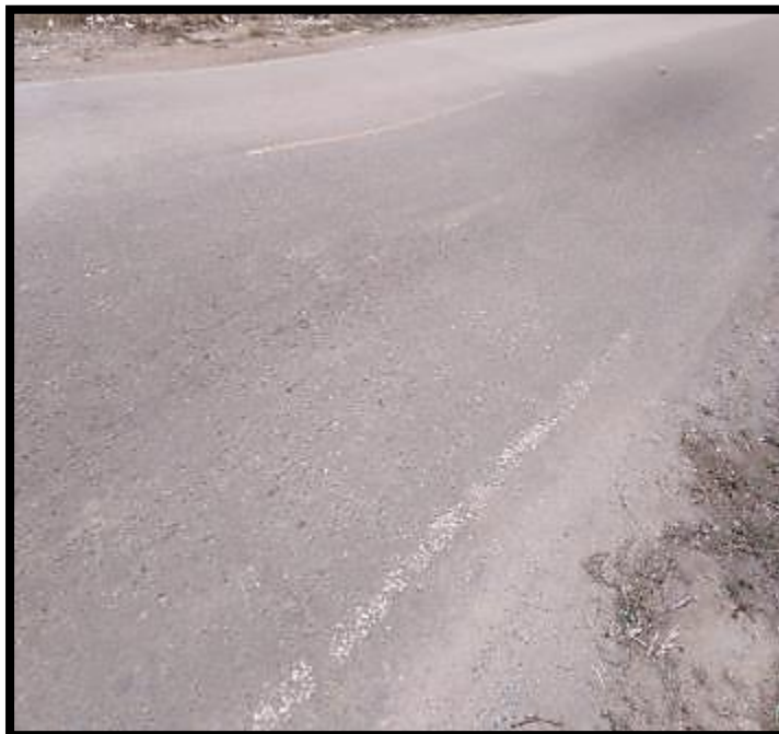
Imagen: Falla de tipo hundimiento
