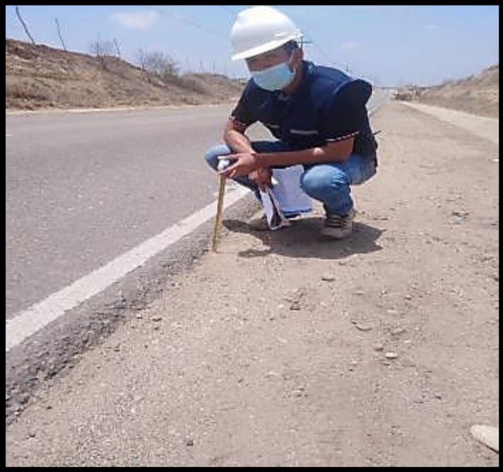
Imagen: Falla de tipo desnivel de berma
