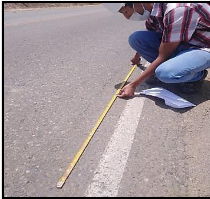
Imagen: Falla de tipo pulimiento de agregados
