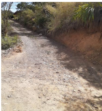
Fig1.1 Estado de la carretera
