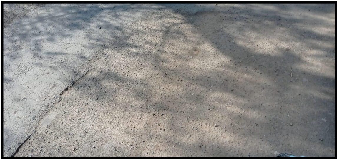
Figura 14. Meteorización y desprendimiento de agregados
