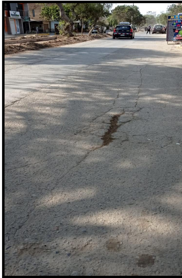
Figura 11. Grietas longitudinales y transversales
