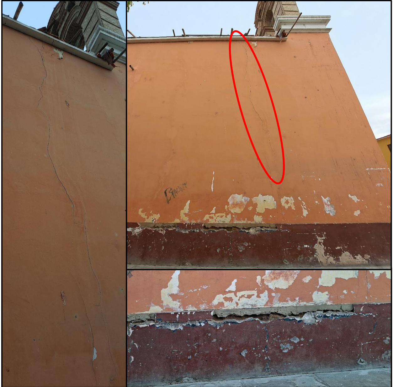
Figura 56. Iglesia La Merced - Muros en estado mediocre con largas y gruesas rajaduras.
