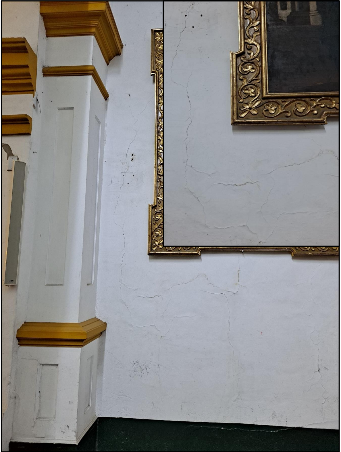
Figura 47. Iglesia San Francisco – Presencia de grietas de gran longitud en muros internos.
