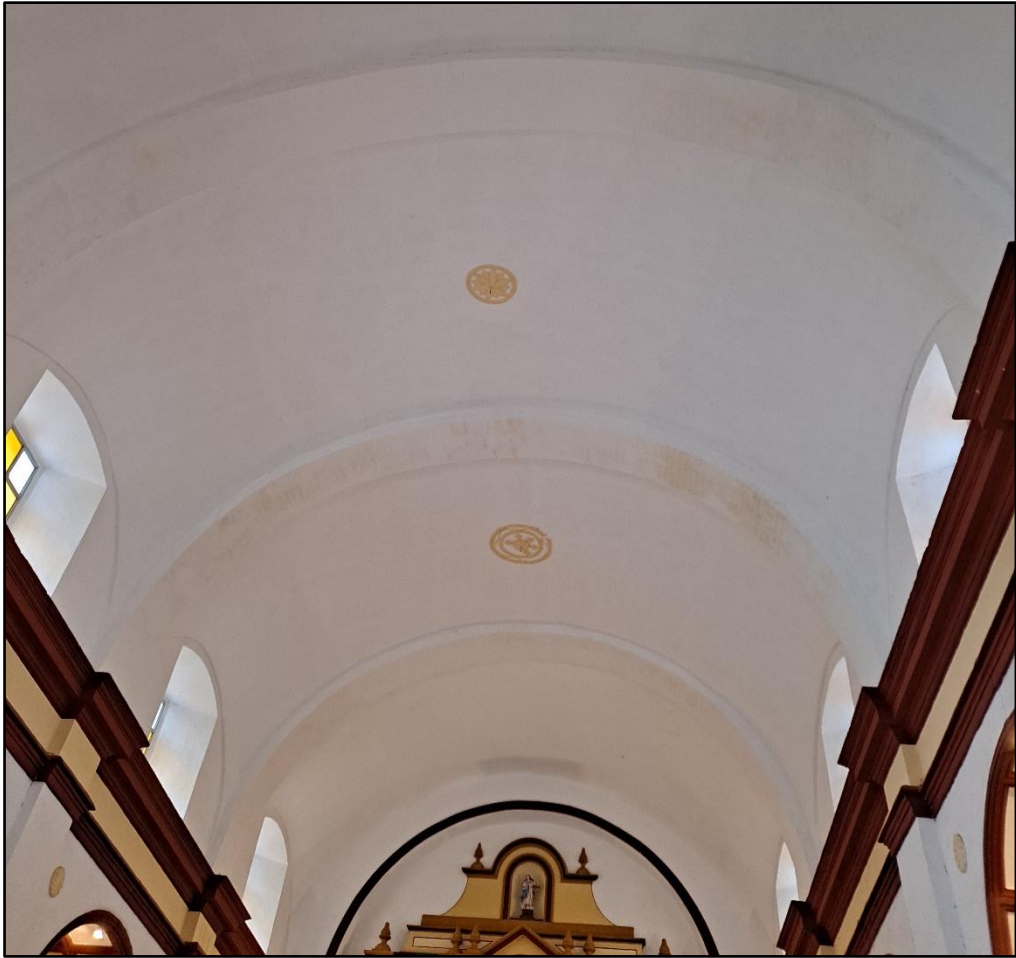
Figura 51. Iglesia Santa Ana - Presencia de estado de cubiertas aceptable con minúsculas grietas.
