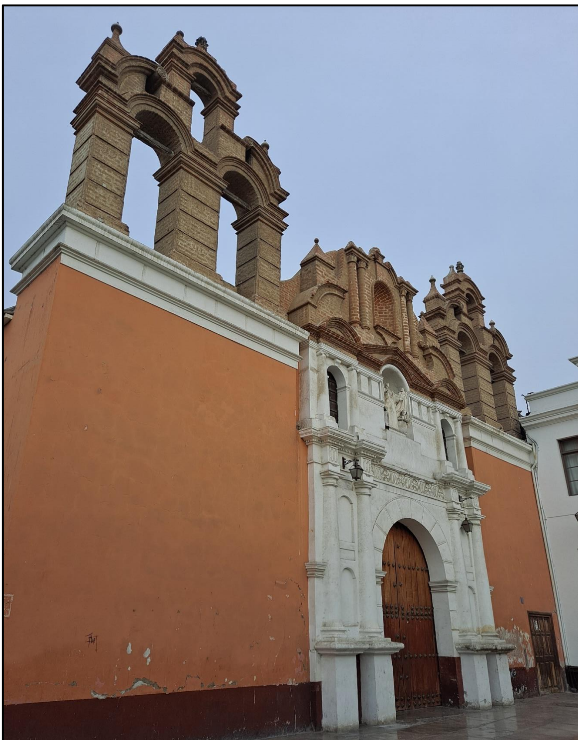
Figura 55. Iglesia La Merced - Fachada principal con presencia de altas espadañas y parte baja del muro en deterioro.
