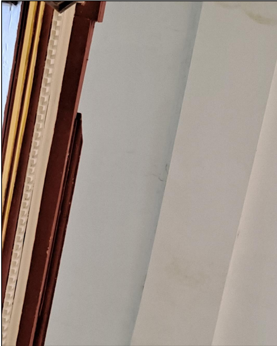
Figura 52. Iglesia Santa Ana - Grietas de corta extensión.
