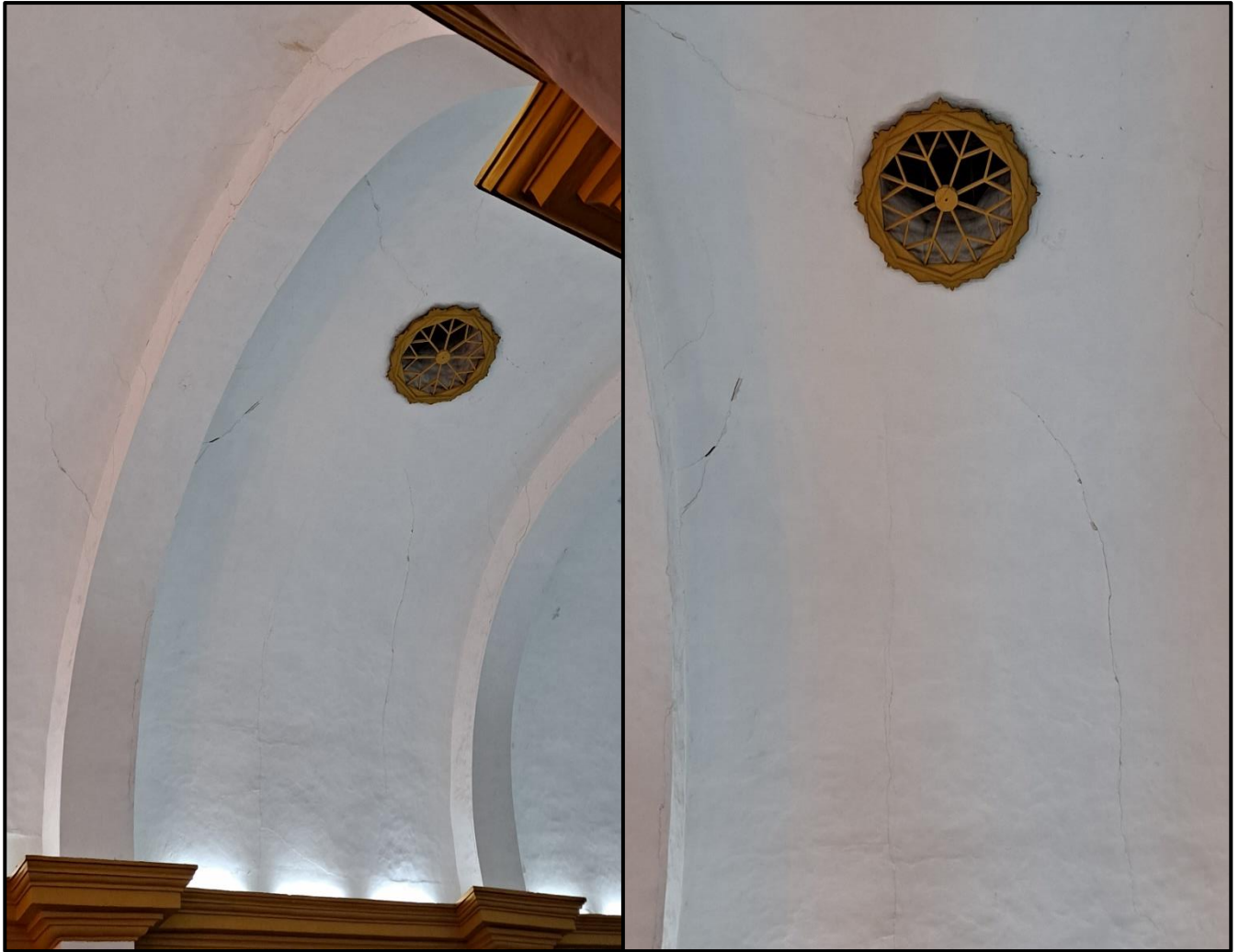
Figura 48. Iglesia San Francisco – Presencia de grietas de gran longitud en cubierta de quincha de las bóvedas.
