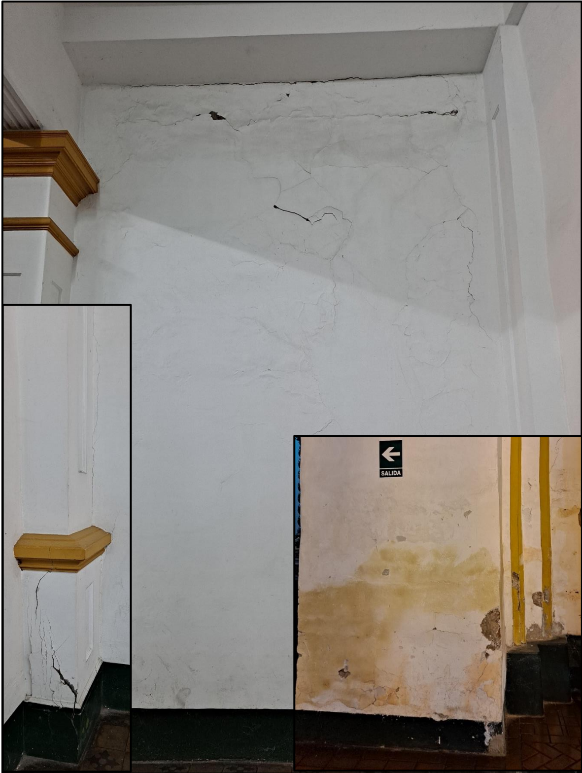
Figura 46. Iglesia San Francisco – Presencia de grietas de gran longitud en muros internos y base de pilares.
