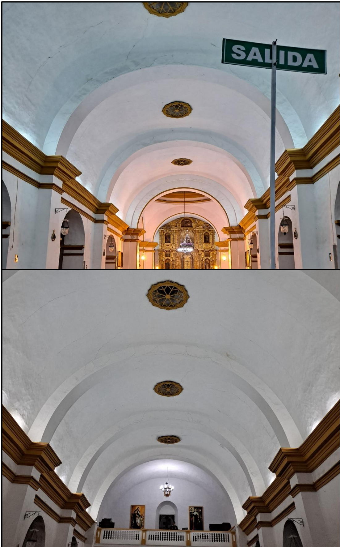
Figura 49. Iglesia San Francisco – Estado de bóvedas y presencia de balcón.
