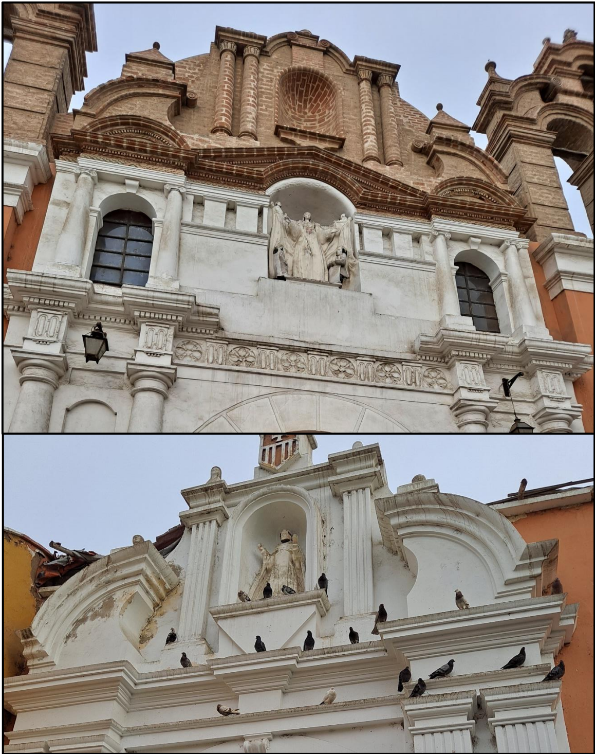
Figura 58. Iglesia La Merced - Elementos no estructurales en altura mal conectados.
