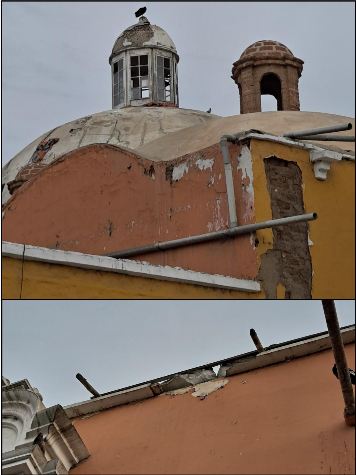
Figura 57. Iglesia La Merced - Cornisas, muros y cúpulas en estado mediocre, evidencia de composición de adobe y ladrillo.
