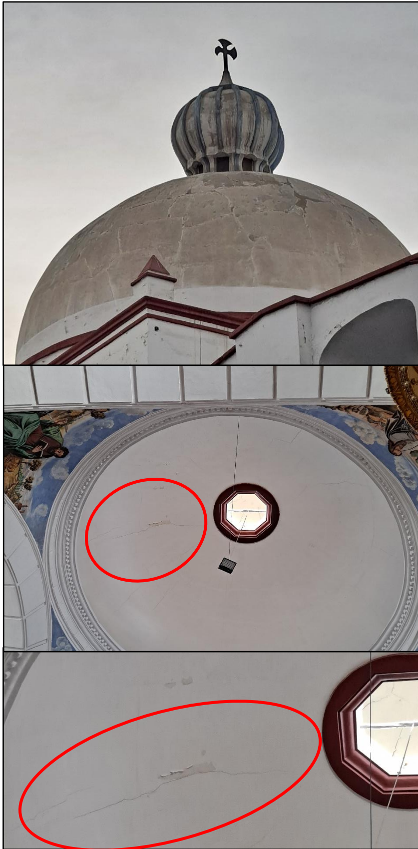
Figura 38. Iglesia Belén Actual - Cúpula de gran altura con presencia de grietas externas e internas.
