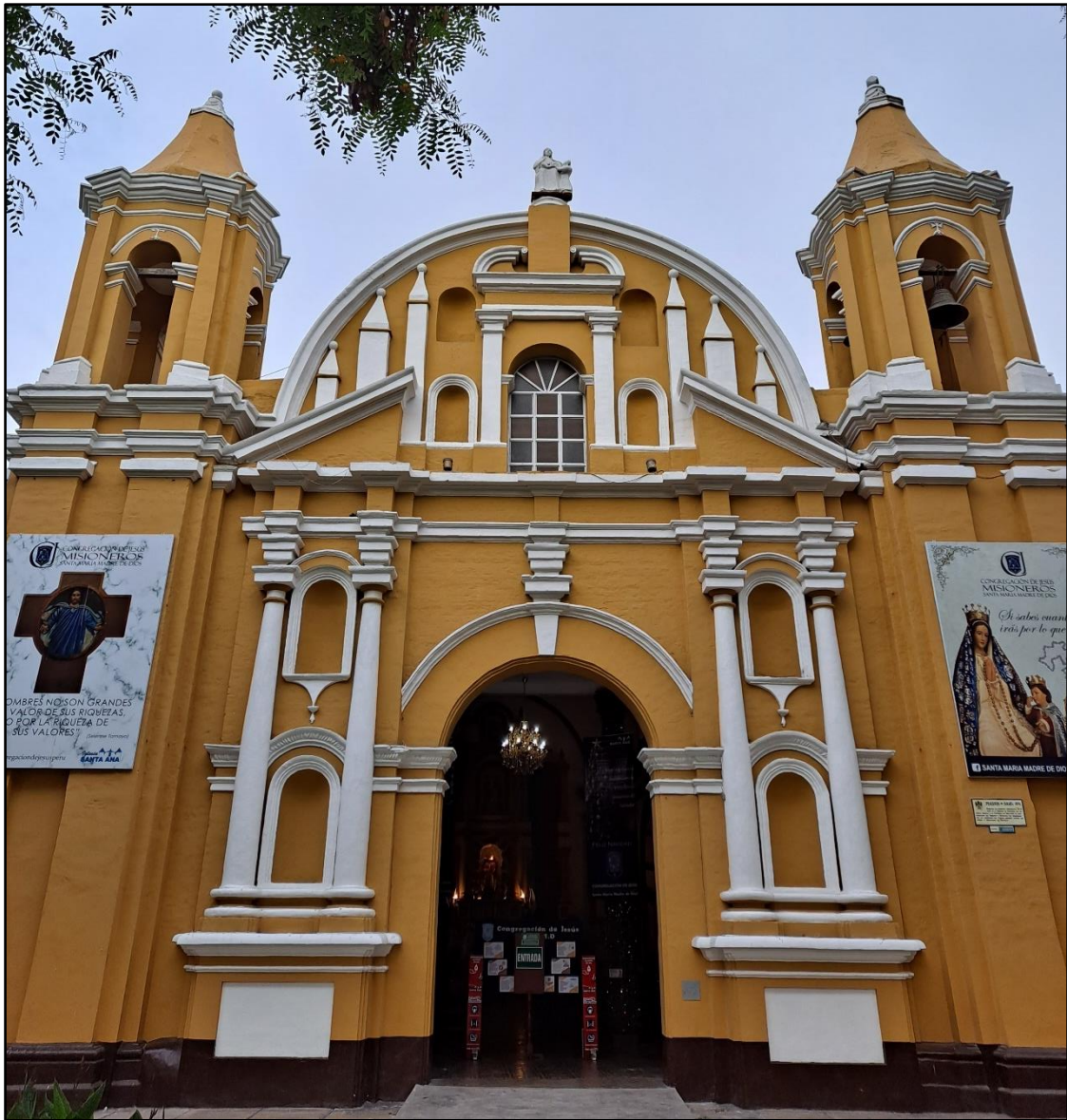
Figura 50. Iglesia Santa Ana - Fachada principal con presencia de elevadas torres, elementos estructurales en altura mal conectados y cornisas.
