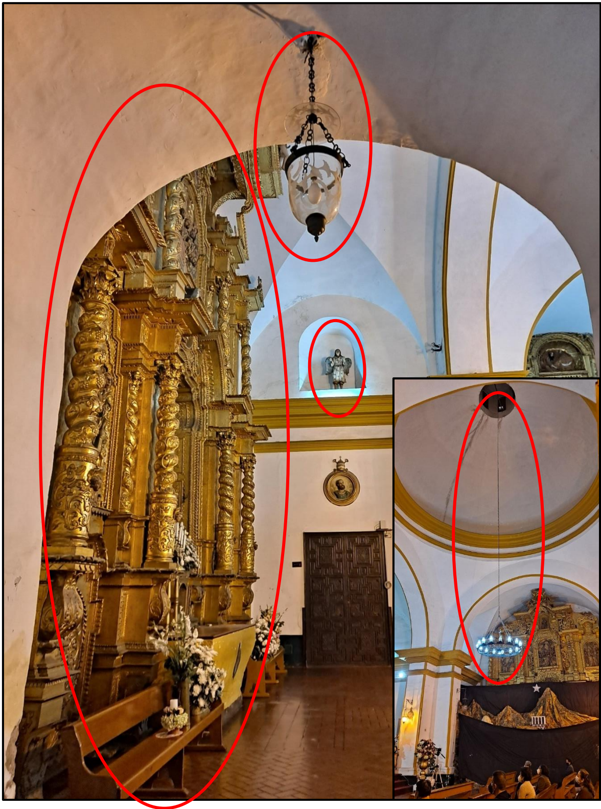
Figura 45. Iglesia San Francisco – Elementos estructurales mal conectados en altura, pequeños y también pesados de gran dimensión.
