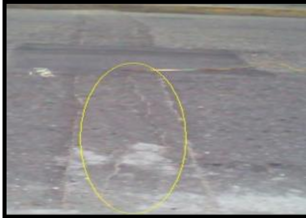
Figura 13. Grietas Transversales Fuente: HERNÁNDEZ, Yelena (2017)
