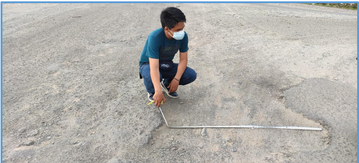
Figura 86. Medición de las fallas encontradas en las Unidades de Muestra
