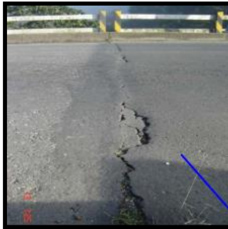
Figura 10. Grieta de Reflexión de Junta Fuente: Manual para inspección visual de pavimentos flexibles, Colombia
