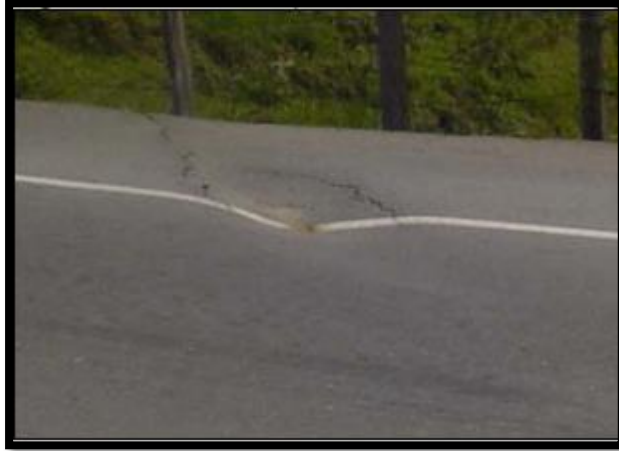
Figura 6. Hundimiento en Pavimento Flexible
