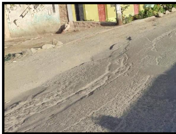
Figura 20. Grieta Parabólica Fuente: Elaboración Propia
