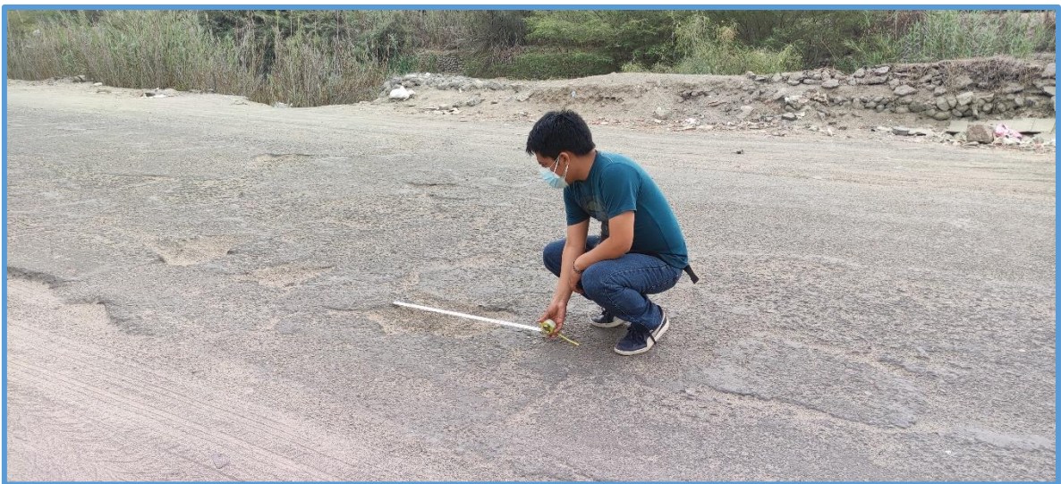
Figura 84. Medición de las fallas encontradas en las Unidades de Muestra
