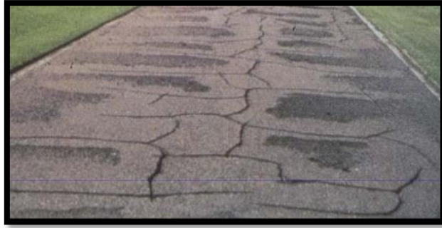
Figura 4. Agrietamiento en Bloque Fuente: maestría en vías terrestres, módulo III
