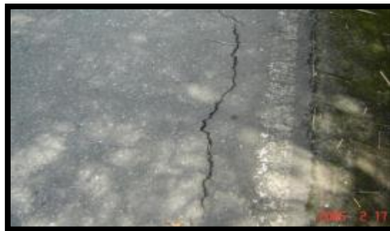
Figura 9. Grieta de Borde
