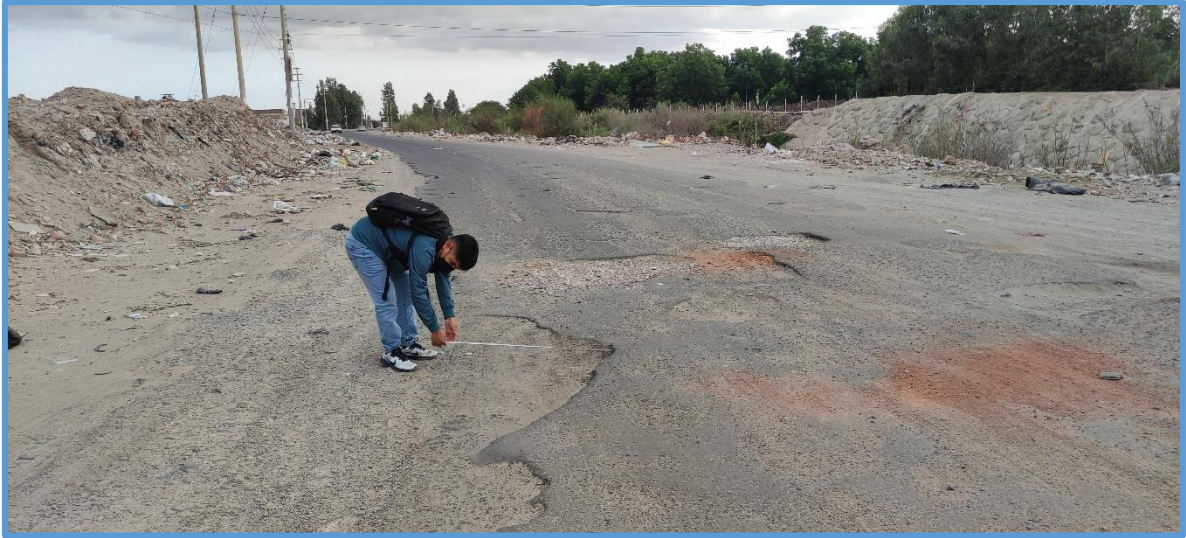
Figura 85. Medición de las fallas encontradas en las Unidades de Muestra
