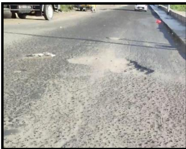
Figura 22. Desprendimiento de Agregados Fuente: Elaboración Propia
