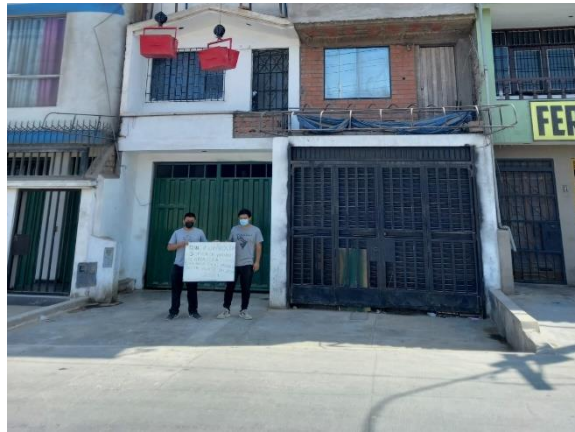
Figura 14. Ausencia de junta sísmica y techo a desnivel
