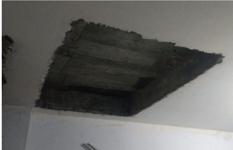
Figura 18. Existencia de junta fría en losa , Fuente: Propia
