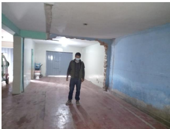
Figura 13. Inadecuada densidad de muros
