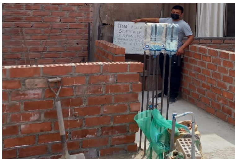
Figura 15. Parapeto del segundo nivel no arriostrado Fuente: Elaboración propia
