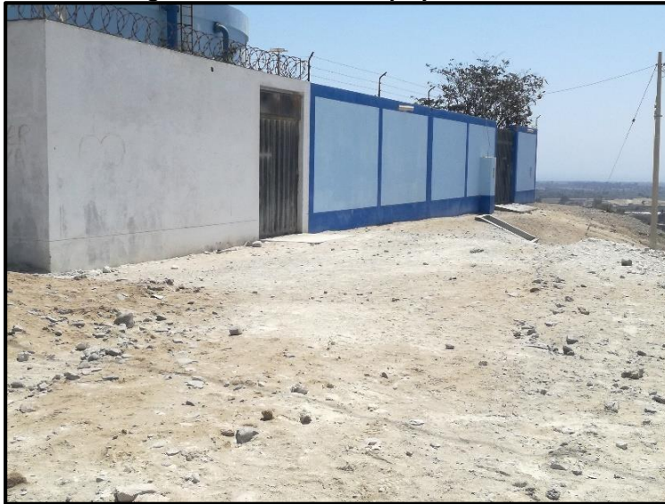
Figura 13: Reservorio Apoyado N° 04
