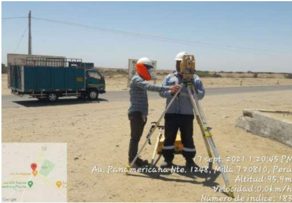
Fotografía 9. Levantamiento topográfico con estación total de intersección "La Campana" de Talara, Piura
