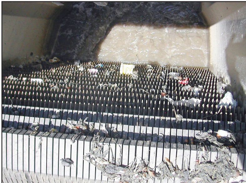
Fig. 5.34 - Vista de una criba mecanizada utilizada en el sistema de pre tratamiento de aguas residuales afluentes a reactores UASB
