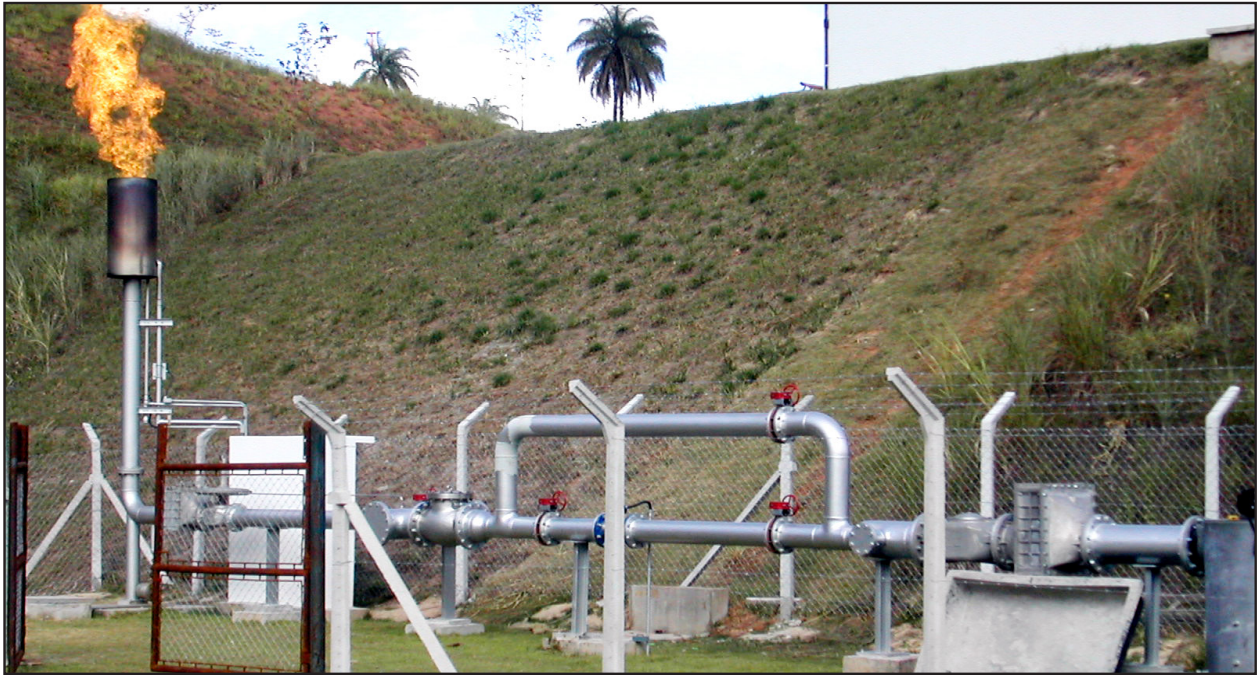
Fig. 5.50 Vista de un quemador de gases de un reactor UASB de gran tamaño: PTAR Onça – Belo Horizonte (COPASA MG)
