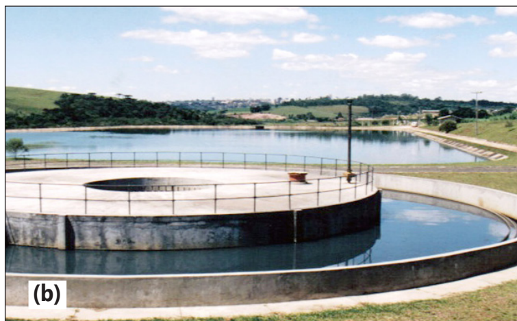
Fig. 5.33 - Vista de reactores tipo RALF (a) PTAR Campo Largo (SANEPAR), (b) PTAR Ponta Grossa (SANEPAR)
