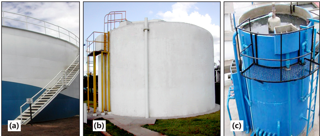
Fig. 5.31 - Vista de reactores UASB de sección circular: (a) PTAR Uberabinha – Uberlândia (DMAE Uberlândia), (b) PTAR Jardim Canadá – Nova Lima (COPASA MG), (c) PTAR Experimental UFMG/COPASA – Belo Horizonte
