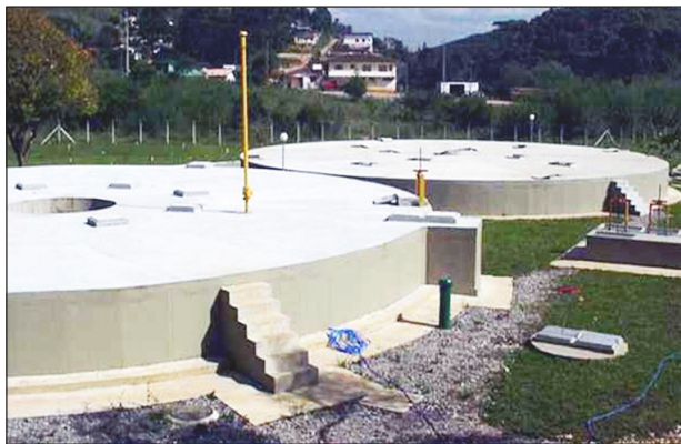
Fig. 5.12 - Filtro anaerobio pos reactor anaerobio (PTAR Colombo - SANEPAR)
