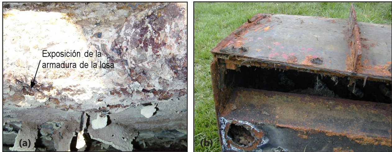
Fig. 5.24 - Ocurriencia de corrosión en estructuras de reactores UASB: (a) cara inferior de la losa de cobertura del sedimentador, (b) parte superior del separador trifásico
