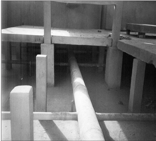
Fig. 5.18 - Dispositivo de distribución de aguas residuales, en el fondo de un filtro anaerobio (ETAR Rio Doce - Ipatinga - COPASA MG)
