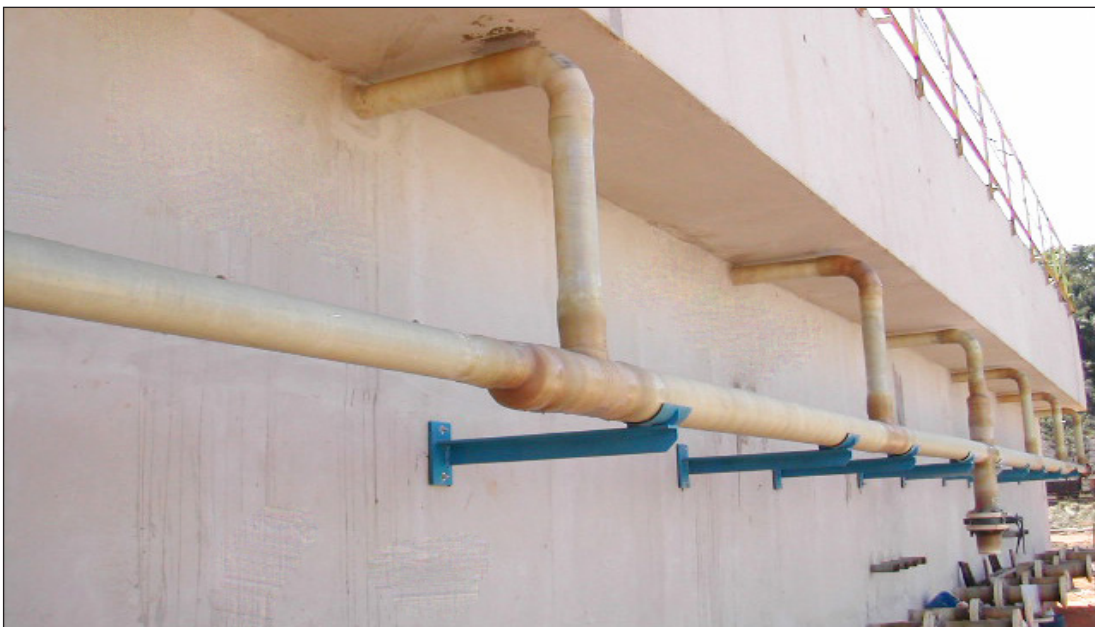
Fig. 5.53 - Conjunto de tubos que se interconectan a las canaletas de remoción de nata localizadas en el interior de los separadores trifásicos: PTAR Rio de Peixe – Itabira (SAAE Itabira)
