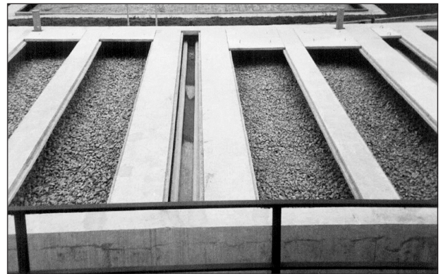
Fig. 5.13 - Filtro anaerobio pos reactor anaerobio (PTAR Rio Doce - Ipatinga - COPASA)
