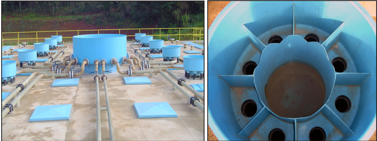
Fig. 5.39 - Cajas de distribución del agua residual afluyente: PTAR Rio de Peixe – Itabira (SAAE Itabira)
