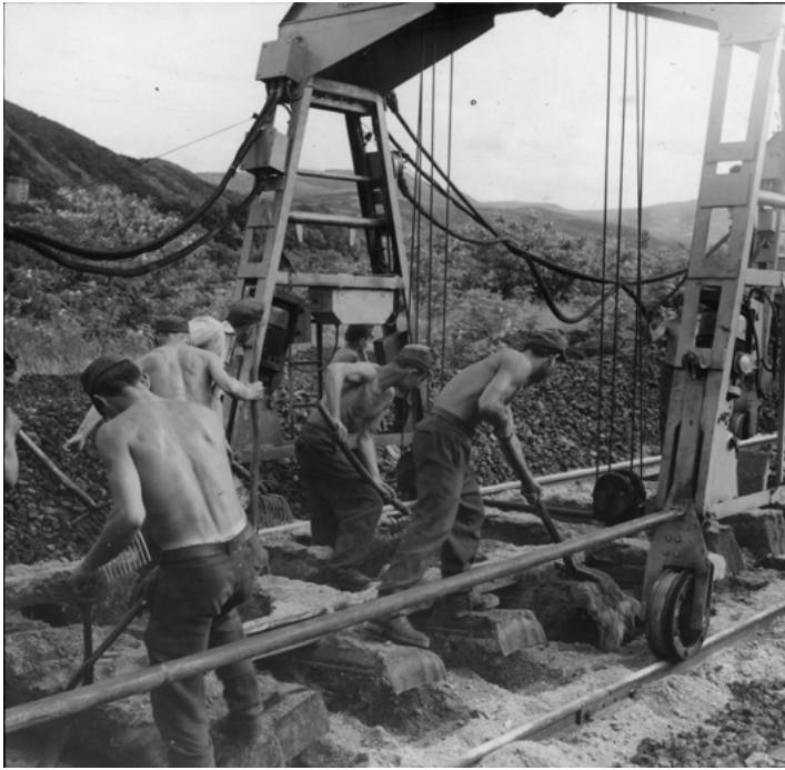
3.kép: Elhasználódott vágányzat bontása portáldaruval, 1971. Érdekesség a Magyarországon kevés helyen alkalmazott vasaljas sínmező. MÁV Archívum X20246478.
