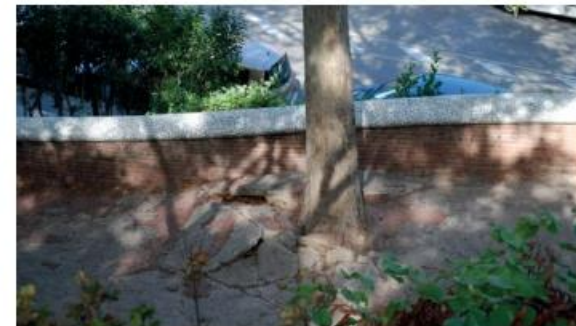
5 Paviment aixecat per les arrels
