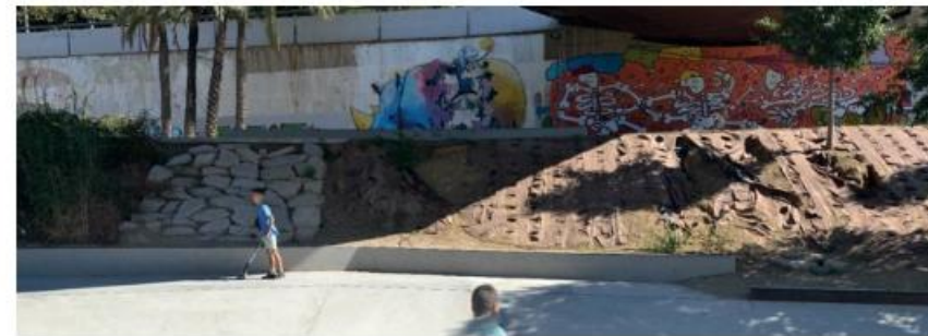
2 Panoràmica del talús descarnat al costat nord-est de la pista de skate amb part de rocalla
