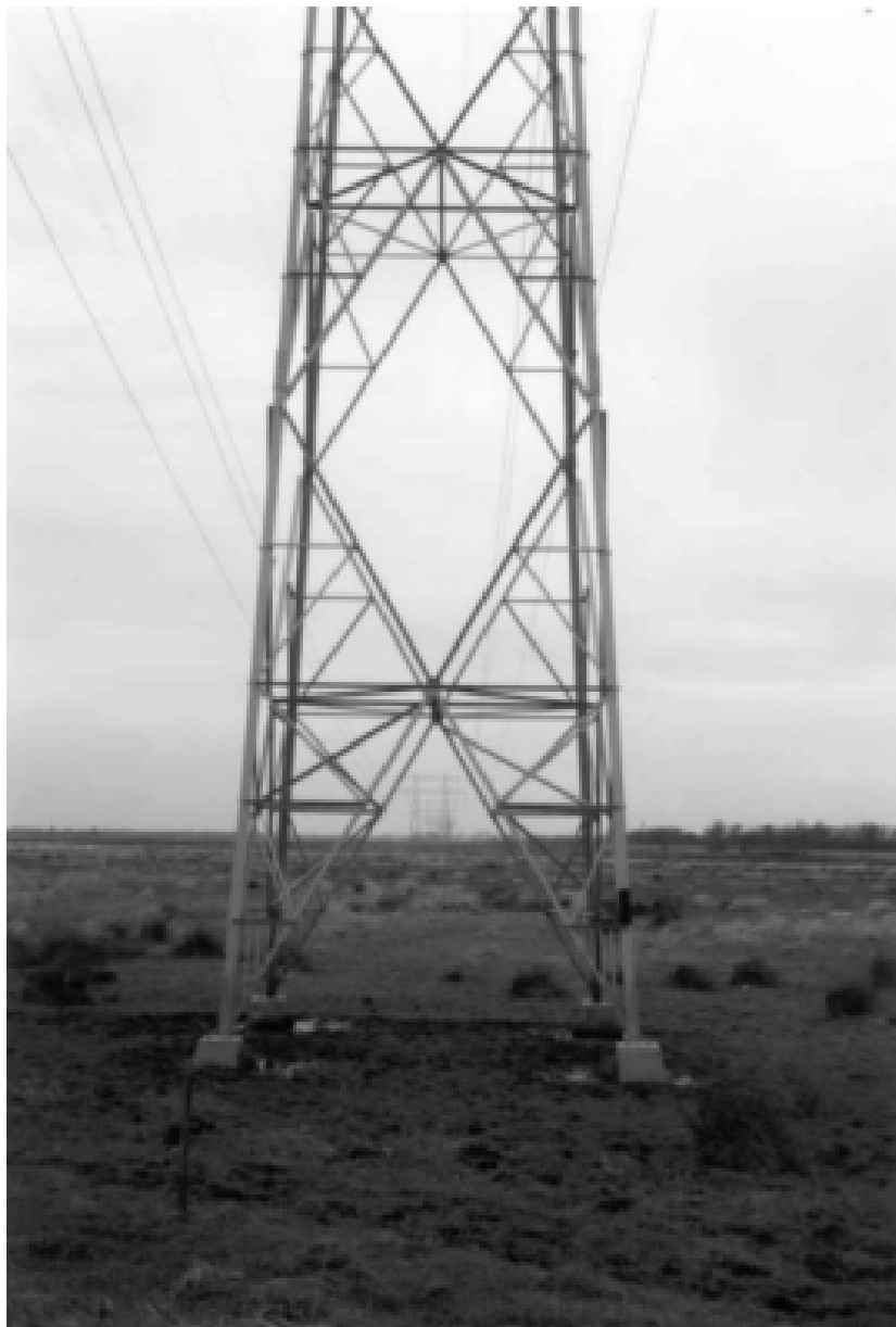
Figuur 2. De hoogspanningslijn in de Westebroekstermadepolder. In de verte is te zien, dat er twee parallelle hoogspanningslijnen lopen. De hoogspanningsmasten hebben ieder twee traversen.
