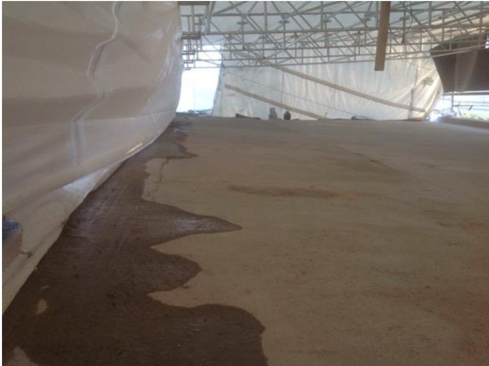
Kuva 24. Sääsuoja on päästänyt sadeveden siltakannelle (Saarinen & Vuorikoski, 2021).
