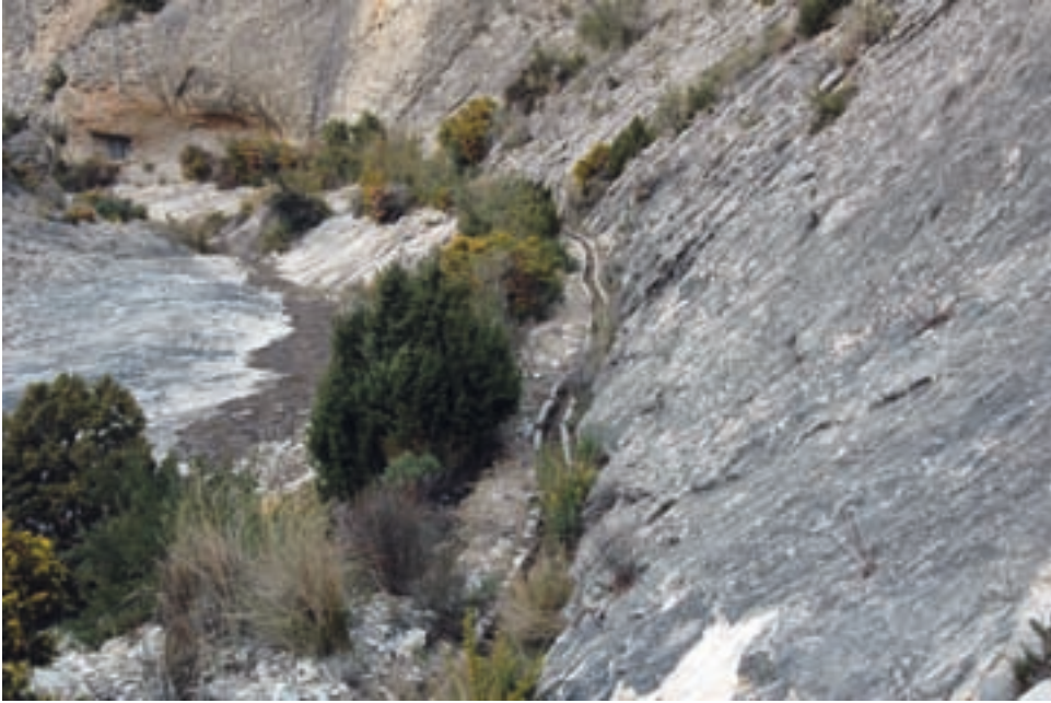
Fig. II-1.90. Tramo de la acequia de La Gurrama tras el Pantanet, hecha conforme a los capítulos redactados en 1678. La mina que la abastece se encuentra en perfecto estado de conservación
