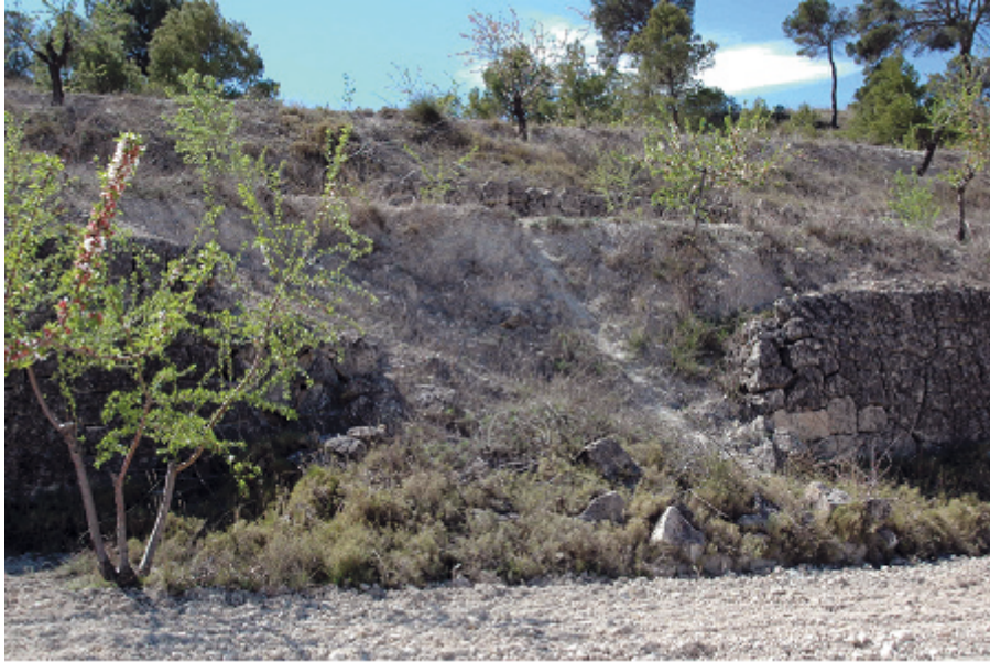
Figs. II-1.129, 1.130, 1.131. Proceso de pandeo y rotura de los muros de mampostería. Els Cotxinets. (Descripción del proceso en: J. PALLARES BOU, 1994, pp. 23-36; J. PALLARES, A. CALVO, 1994, pp. 135-148)
