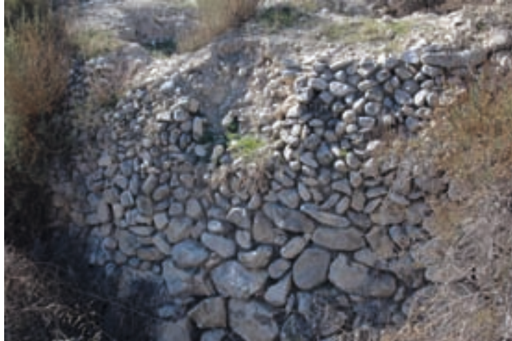
Fig. II-1.20. Pared levantada con bolones de la rambla de Puça, cerca del acueducto de San Rafael
