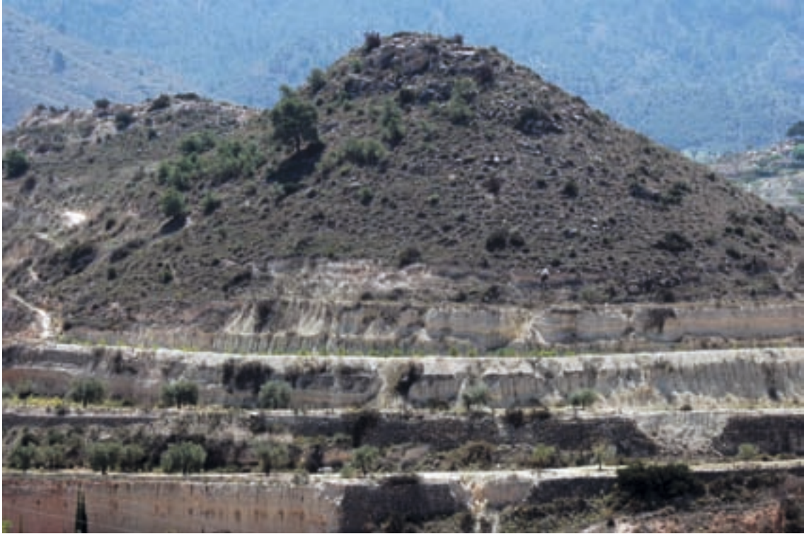
Fig. II-1.134. Erosión debida al desmoronamiento de las paredes de piedra de los bancales. Sobre la rambla de Puça
