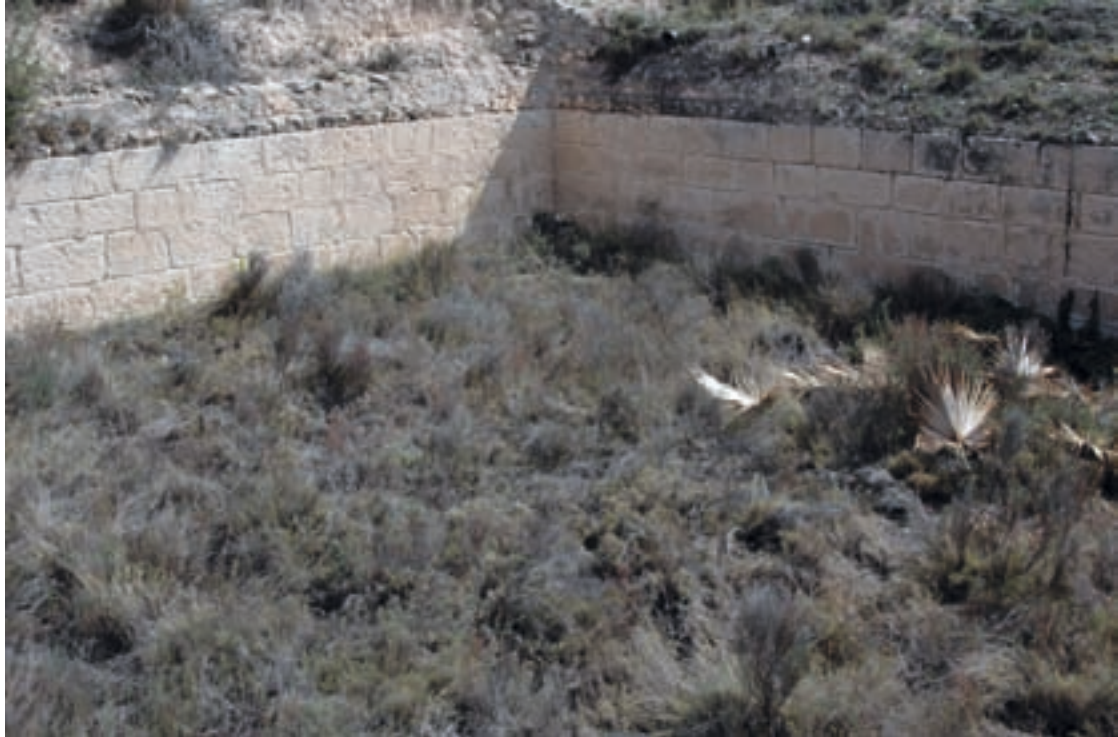
Fig. II-1.94. Balsa de Ginés Juan, del siglo XVIII, conocida posteriormente como de la casa de la Señora. En el año 2009 los sillares han sido recubiertos con cemento
