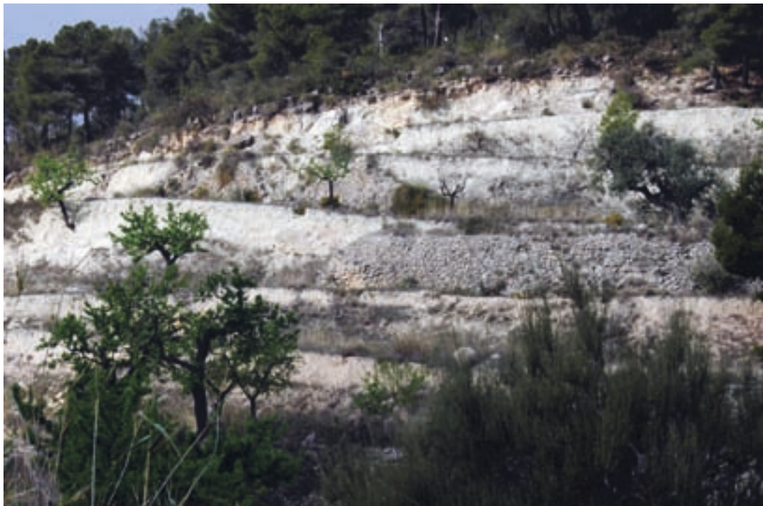
Fig. II-1.55. Ausencia de tareas de mantenimiento en los muros de los bancales sobre margas fácilmente erosionables, en donde alternan las piedras, con el desarrollo incipiente de la vegetación y con tramos de lomo desnudo. Casa de Monis
