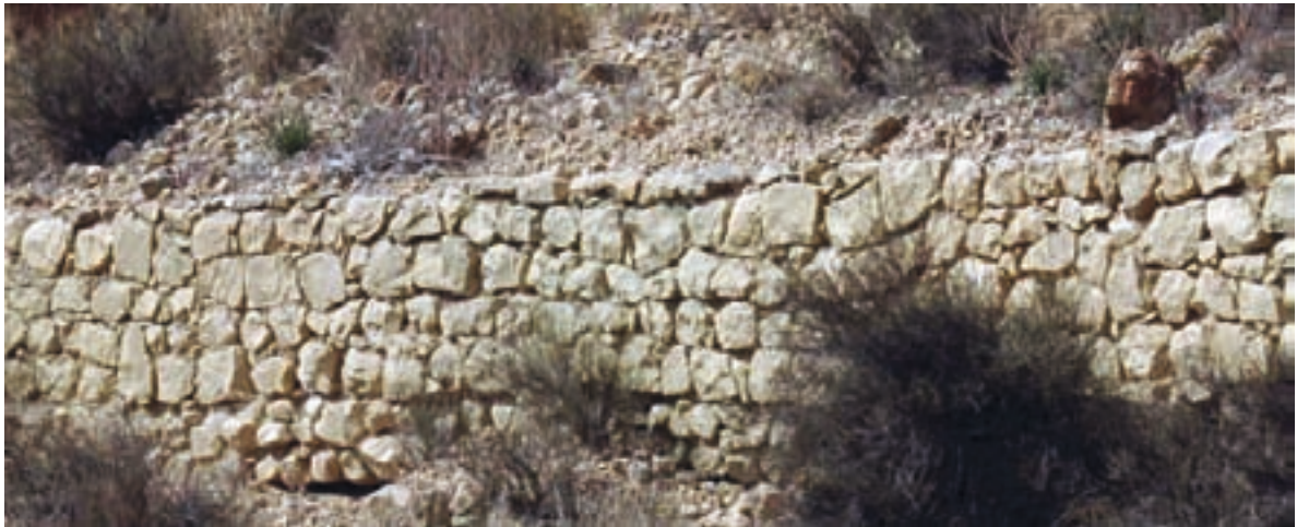
Fig. II-1.38. Muro de mampostería sin salientes gracias al aparejo irregular muy labrado, en el Marquesat de Noguera
