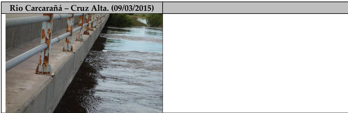
Figura 38. : Condiciones de flujo de los ríos al momento de determinar la capacidad de los cauces.
