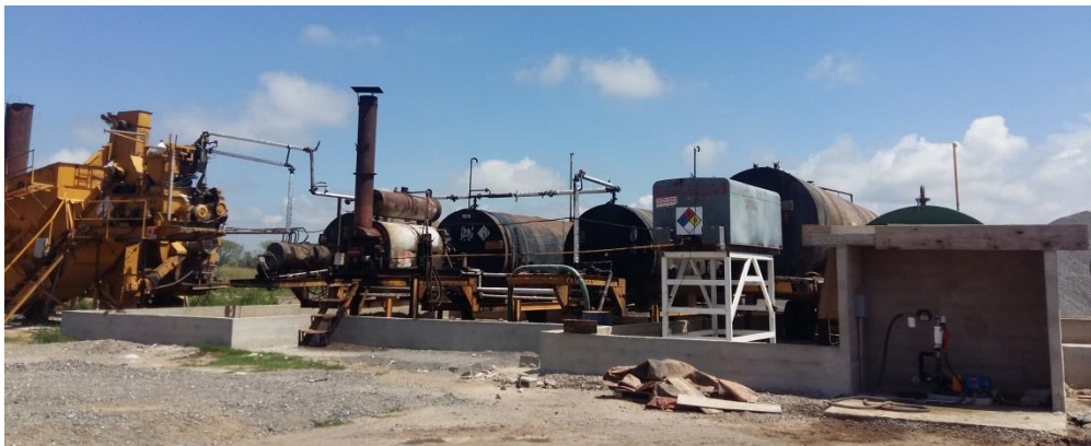
Figura 10-4: Tanque de almacenamiento de fueloil, cemento asfáltico, gasoil y emulsión para imprimación
