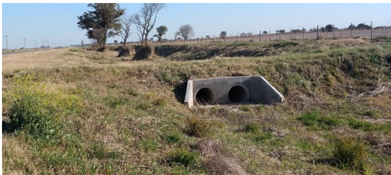
Figura 1-8: Alcantarilla longitudinal para el acceso a propiedades o cruce de camino vecinales
