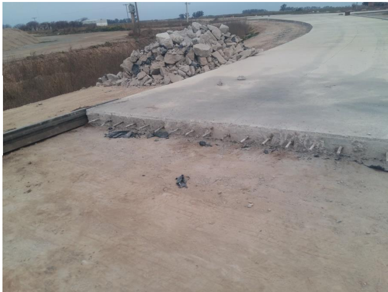
Figura 8-18: Acopio de escombros producto de la demolición y colocación de moldes para reconstrucción de losa
