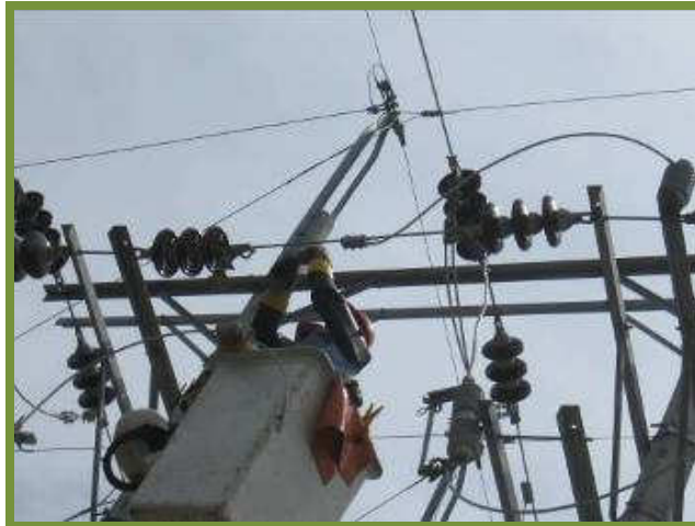
Fuente: BASTO, Jessica Paola. Proyecto Construcción de facilidades eléctricas para el sector petrolero. Neiva. 2010
